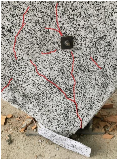
Resim 5.9. 'Resim 5.8'de gözlemlenen kılcal çatlakların işaretlenmiş durumu
