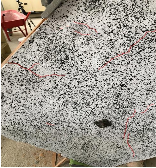
Resim 5.22. ‘Resim 5.21’de meydana gelen kılcal çatlakların işaretlenmiş durumu
