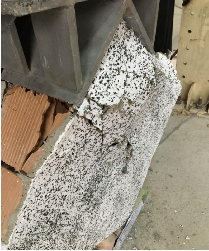
Resim 5.40. b) Diagonal yükleme sonrası çift yüzü Tür 1 ile güçlendirilmiş 2. tuğla duvar numunesinin ön yüzü
