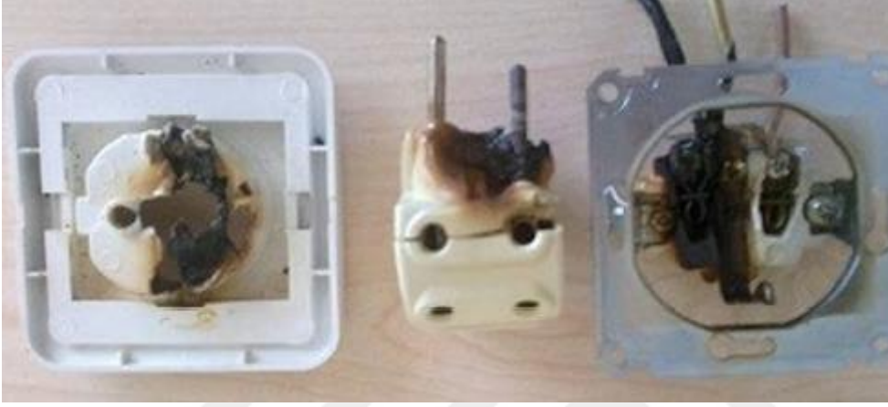
Şekil.8. Elektrik Prizlerinde Oluşan Yangın Tahribatı
