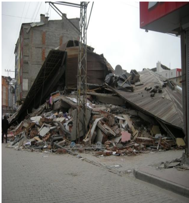
Şekil 2.18: Tamamen göçüp enkaz haline gelen binalar.
