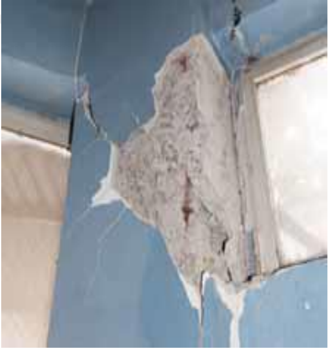
Şekil 2.20: Kısa kolon davranışı ile ilgili gözlemler.
