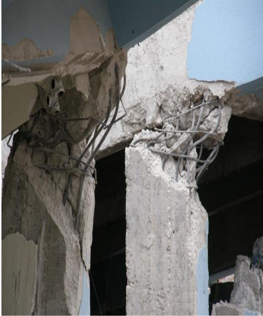
Şekil 2.21: Güçlü kolon zayıf kiriş etkisi ile ilgili gözlemler.
