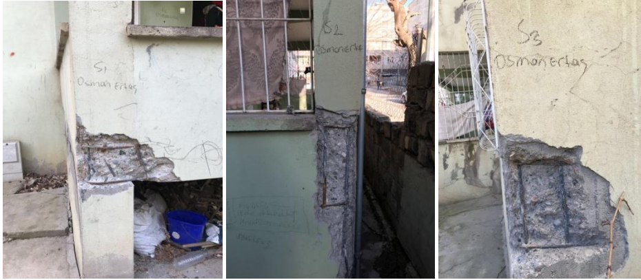
Şekil 3.22. D yapısına ait kolon sıyrma görüntüleri
