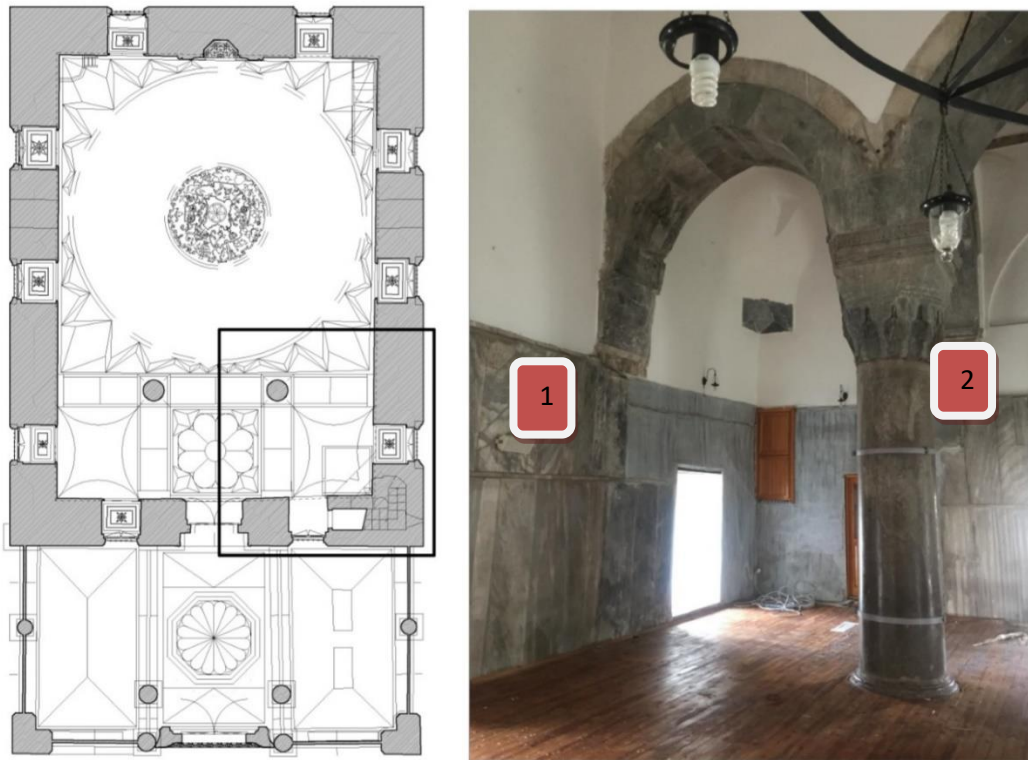
Şekil 7.4. Cami giriş kısmı batı cephesi – deformasyon oluşmuş sütun ve alan
