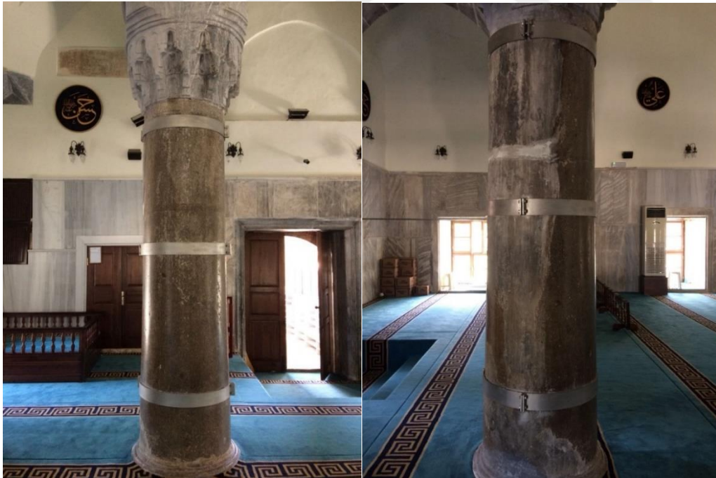
Şekil 7.37. Yapının güncel durumu ve cami giriş kısmında bulunan sütuna yapılan güçlendirme örneği
