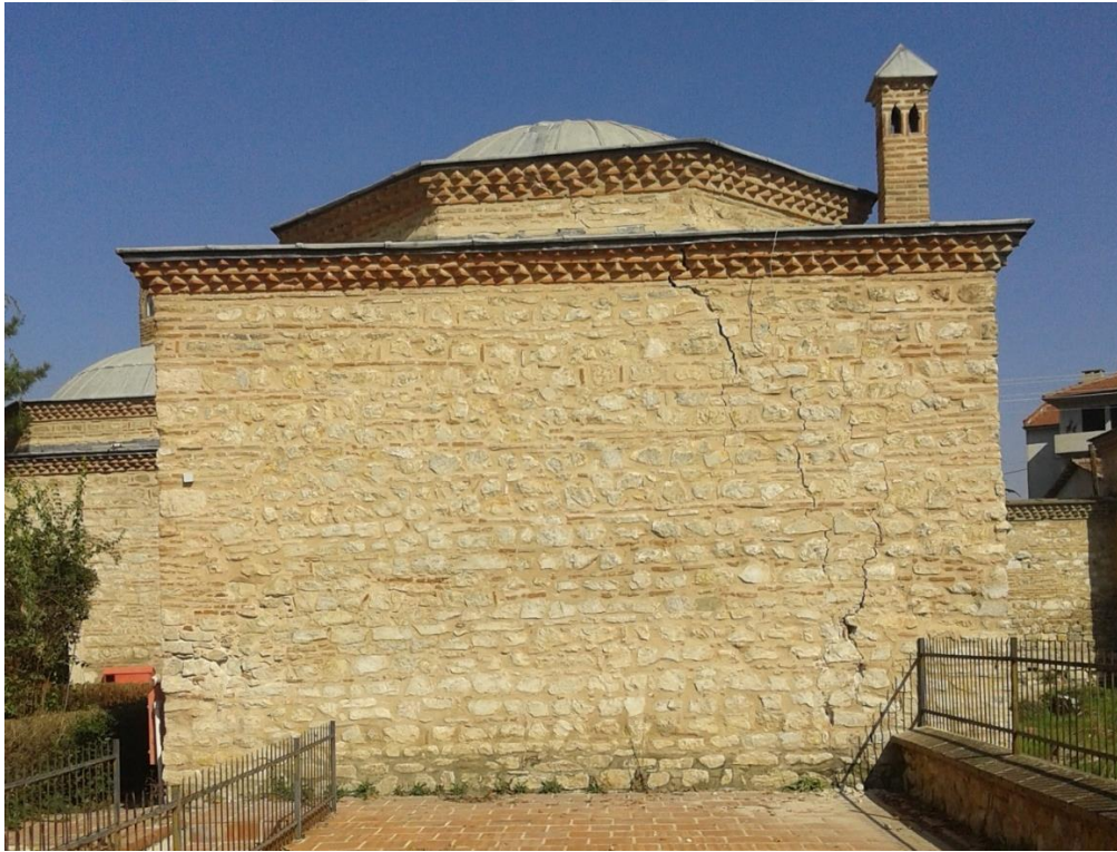
Şekil 5.2. Yığma yapı duvarda çatlak oluşumu (Bursa Yenişehir Sinanpaşa İmaret)
