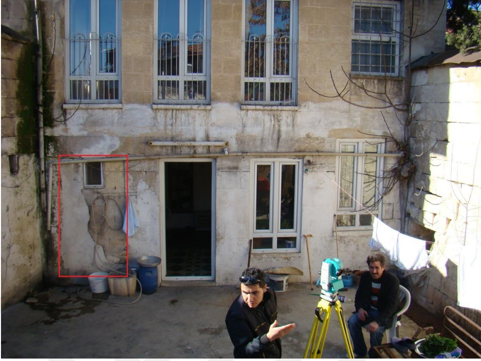
Resim 18- Doğu Cephe ve Kapatılmış Pencere
