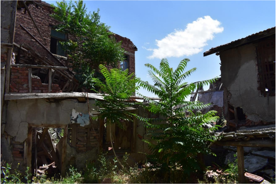
Fotoğraf 218: Yeni Han Avluda Yıkılan Bölümlerden Görünüm
