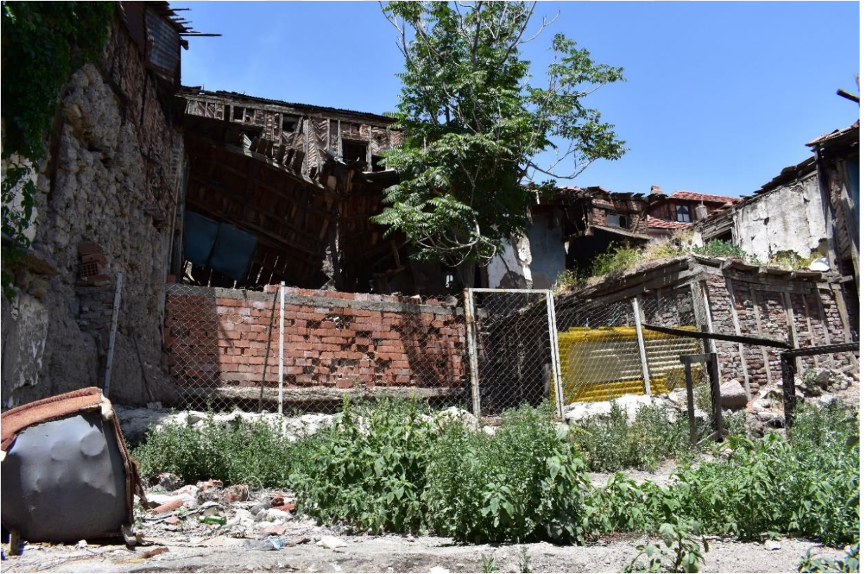
Fotoğraf 230: Kıbrıs Han Güney Cephesi Yıkılan Bölümden Görünüm
