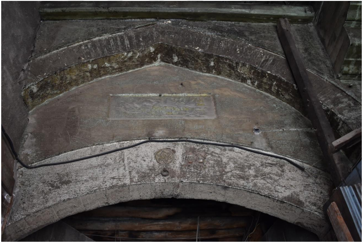
Fotoğraf 192: Pilavoğlu Han Giriş Kapısının Üzerindeki Kitabe Boşluğu
