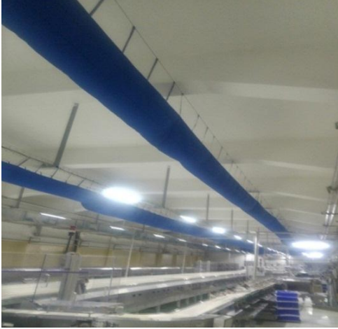
Şekil 4-16 Paketleme bölgesi havalandırma kanalları
