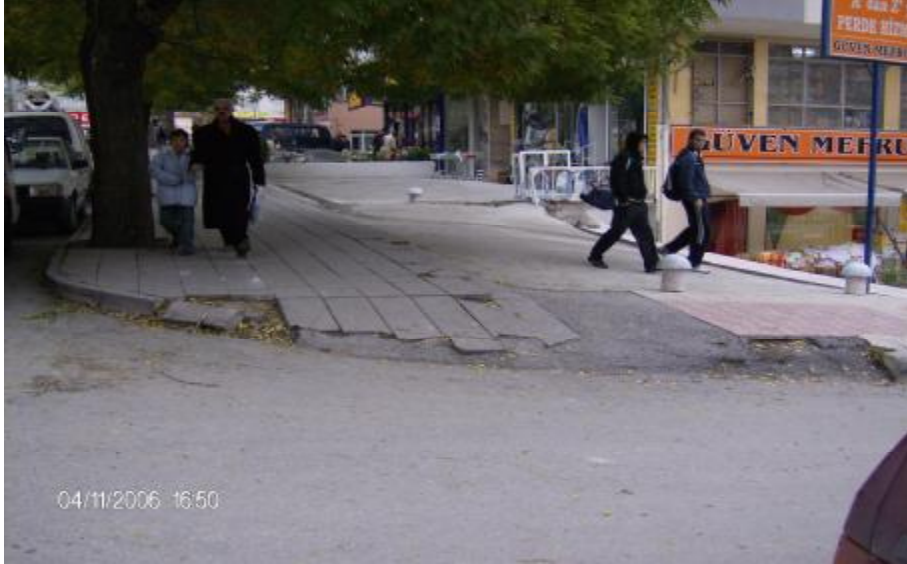
Şekil 4.24. Ankara şehri onarılmamış kaldırım rampa düzenlemesi
