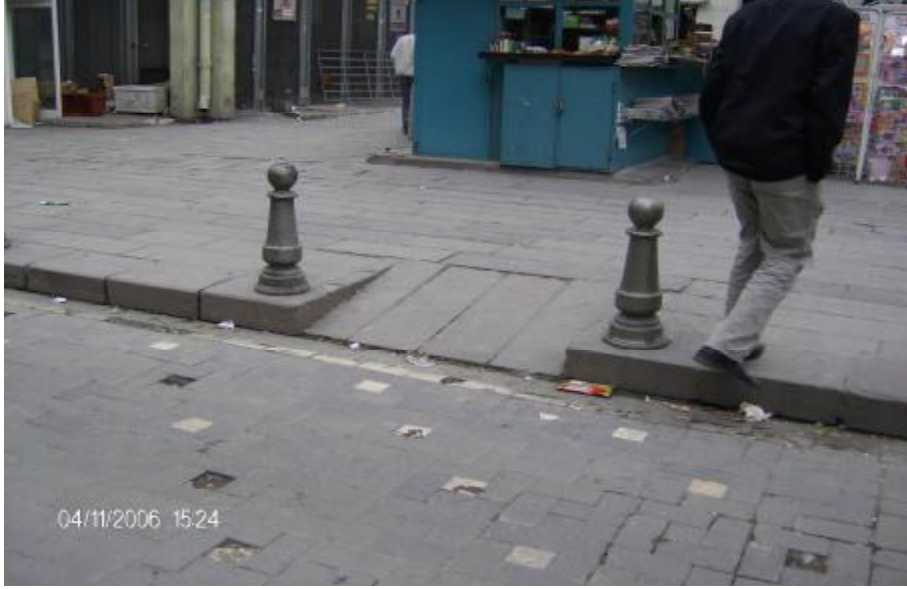
Şekil 4.23. Ankara şehri uygun olmayan kaldırım rampa düzenlemesi
