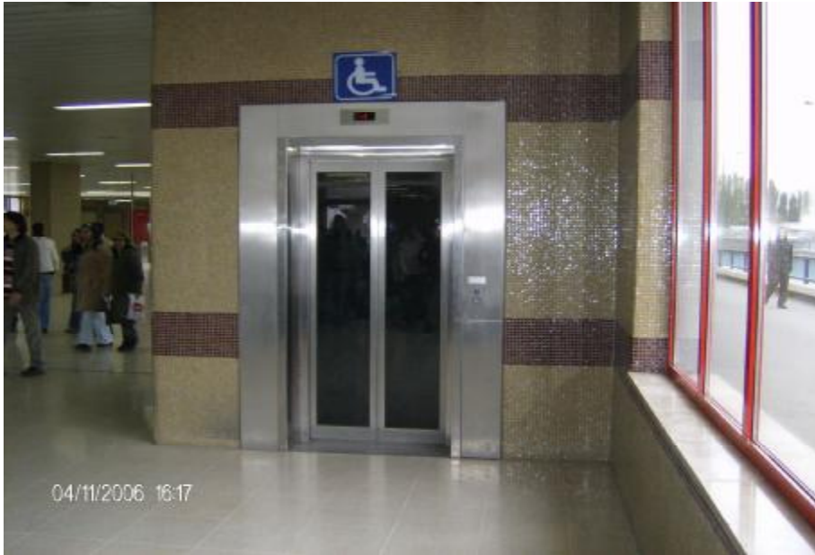
Şekil 4.21. Ankara şehri metrosu engelli asansörü
