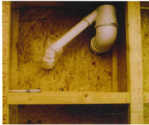
Resim 6.11 Pis su tesisatı
