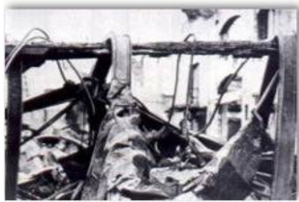
Resim 4.11 Yangın sonrası ahşap ve çeliğin durumu
