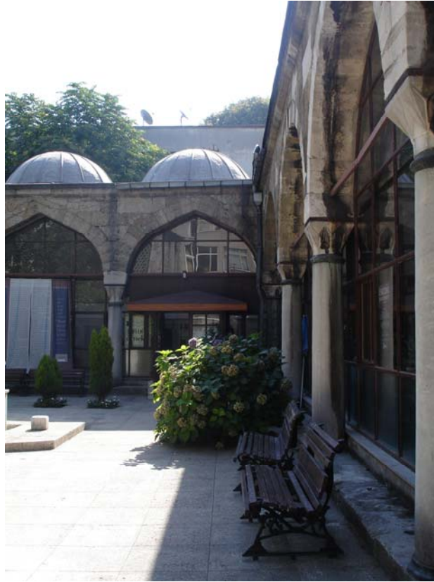
Şekil 5.29. Köprülü Medresesi'nin Avlusundan Bir Görünüm ( Sütunlarda ve kemerlerde jips oluşumu sonucu ortaya çıkan kararmalar)
