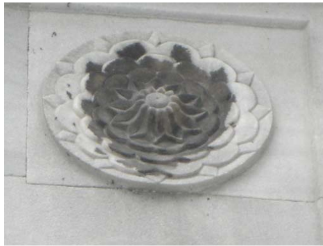
Şekil 5.31. Köprülü Medresesi'ne ait çeşmedeki rozette gözlemlenen bozunmanın yakından görünümü
