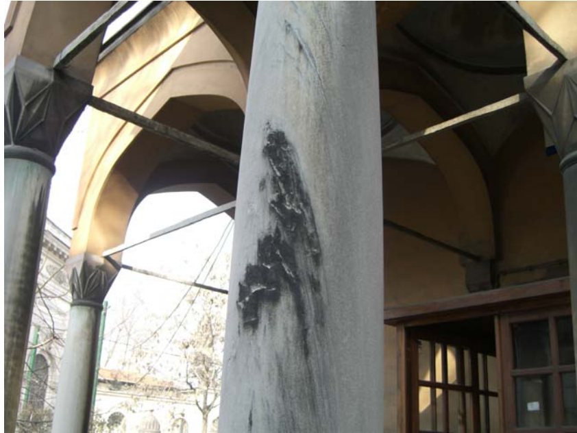
Şekil 5.24. Köprülü Kütüphanesi Sağ Sütunda Jips Oluşumunun Görsel Tespiti (S17 Kodlu Numune)
