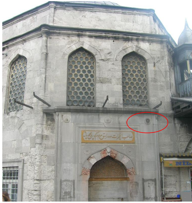
Şekil 5.30. Köprülü Medresesine Ait Çeşmenin Görünümü (Jips oluşumu gözlemlenen rozet kırmızı ile işaretlenmiştir.)
