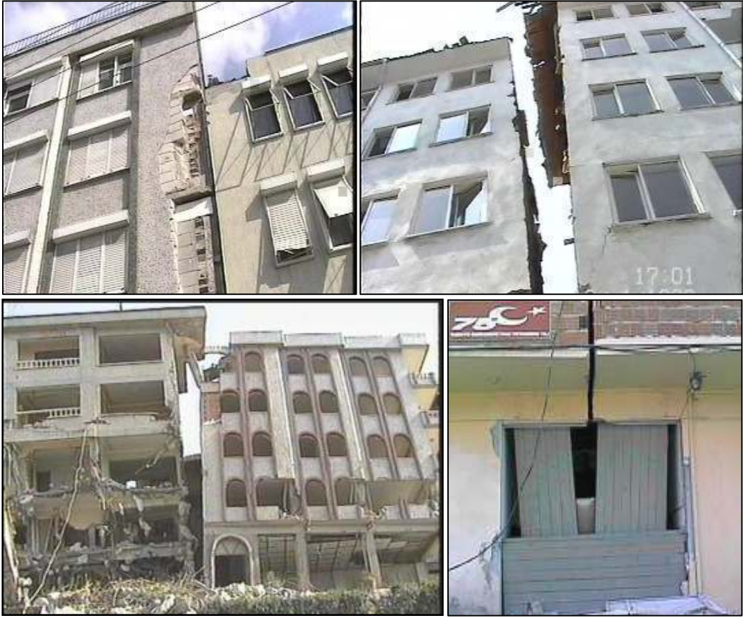
Şekil 3.11. Bitişik yapılmış yapıların çarpışması ile meydana gelen hasarlar [21]
