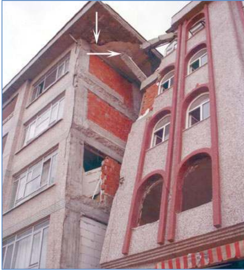
Şekil 3.2. Çarpışma sonucu hasar gören taşıyıcı sistem [21]
