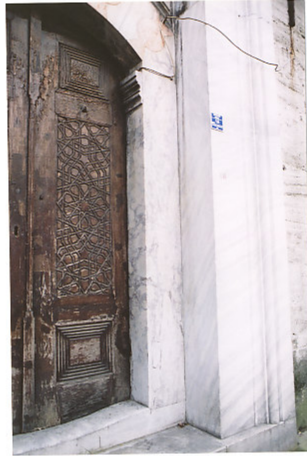
Fotoğraf 52 : Kanat Kapısı (Doğu) Söve ve Söve konsolu
