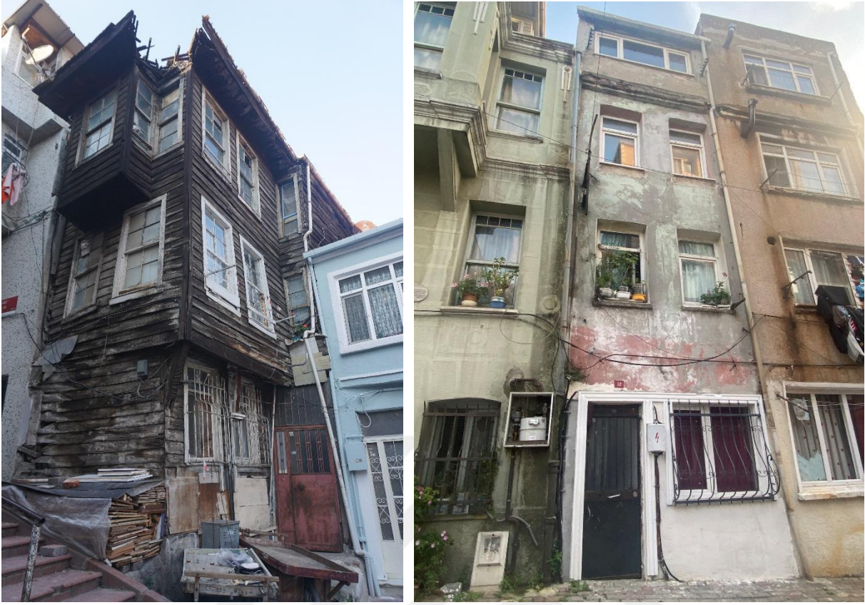
Şekil 4. 33 Fiziksel eskimeye uğramış içerisinde kullanıcı bulunduran 1879 ada 31 parsel, 1890 ada 36 parsel, 1899 ada 4 parsel, 1907 ada 4 parsel ve 1908 ada 35 parselde yer alan yapılar.
