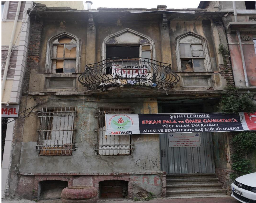
Şekil 3. 2 Fiziksel eskimeye uğramış durumdaki metruk yapı (İMOS, 2023)
