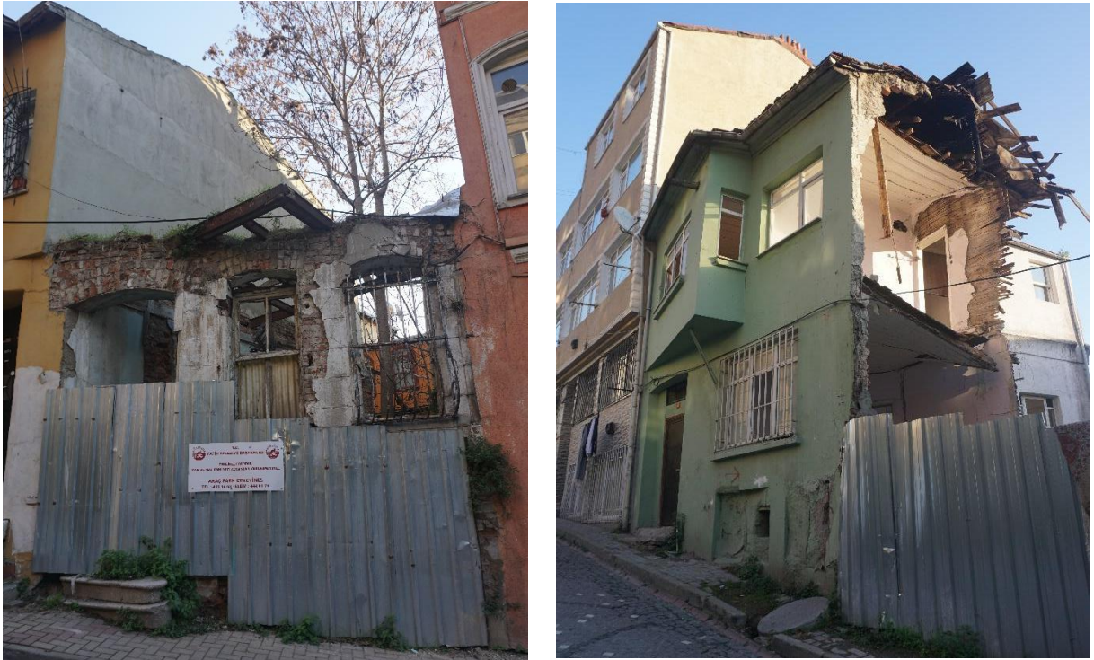
Şekil 4. 30 1889 ada 4 ve 7 parselde yer alan mail-i inhidam durumunda bir kısmı çökmüş yapılar
