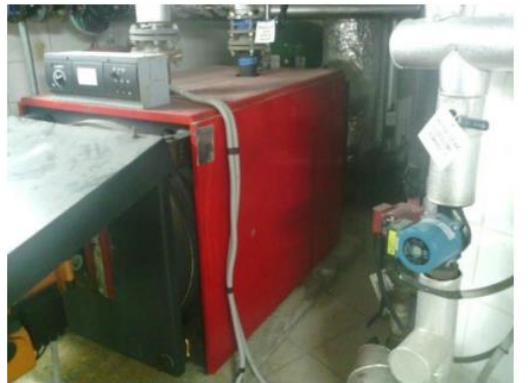
Şekil 15 IR130 Sıcak Su Kazanı Sağ YanYüzey
