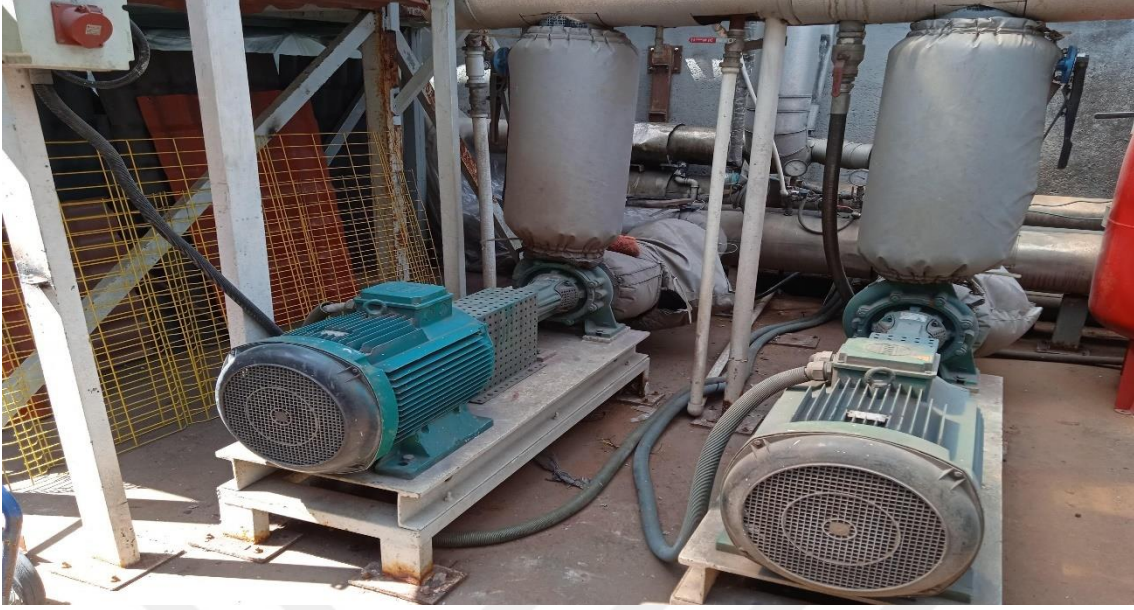
Şekil 47: Pompa 2 Genel Görüntüsü
