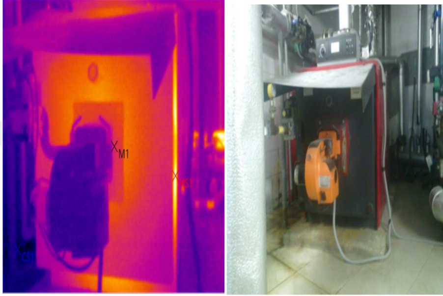
Şekil 5: Sıcak Su Kazanı Ön Yüzey
