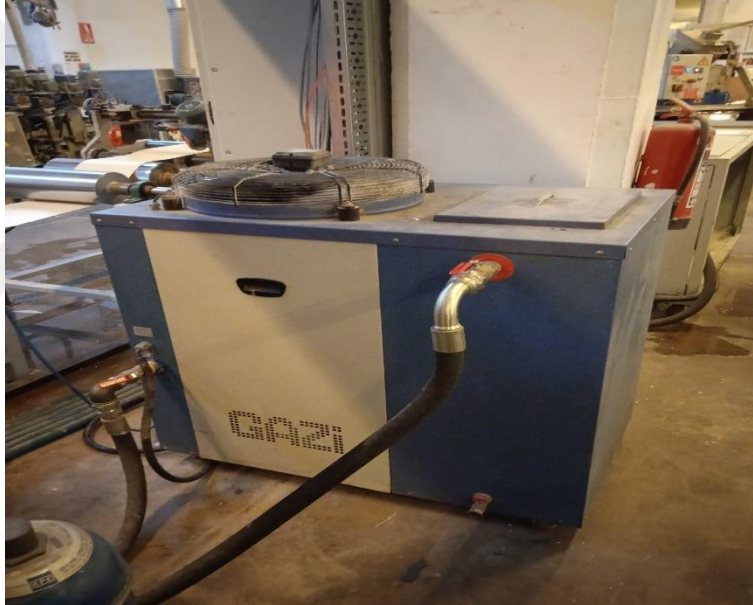
Şekil 28 : KF-6 Chiller Genel Görüntüsü
