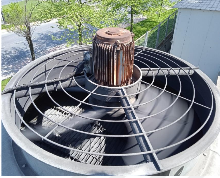
Şekil 51: Soğutma Kulesi 2 Fan
