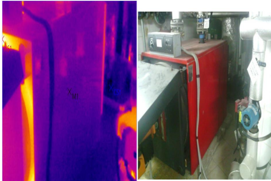
Şekil 6: Sıcak Su Kazanı Yan Yüzey
