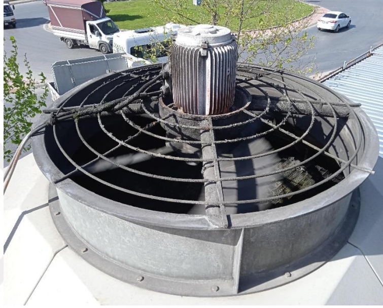
Şekil 50: Soğutma Kulesi 1 Fan
