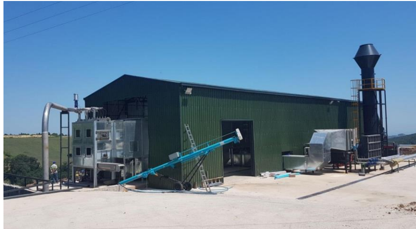
Şekil 2.1. Bantlı atık çamur kurutma tesisi
