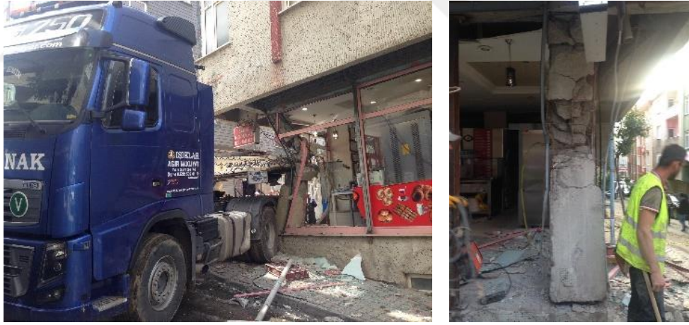
Şekil 1.1 : Betonarme bir yapıda darbe hasarı örneği.
