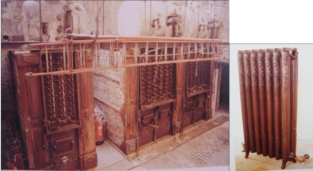
Şekil 2.44: Dolmabahçe Sarayı'na 1911 yılında yerleştirilmiş Fransız yapımı sulu sistem kalorifer kazanı ve salonlara yerleştirilmiş kabartma Rokoko kıvrımlarla süslü döküm kalorifer peteği
