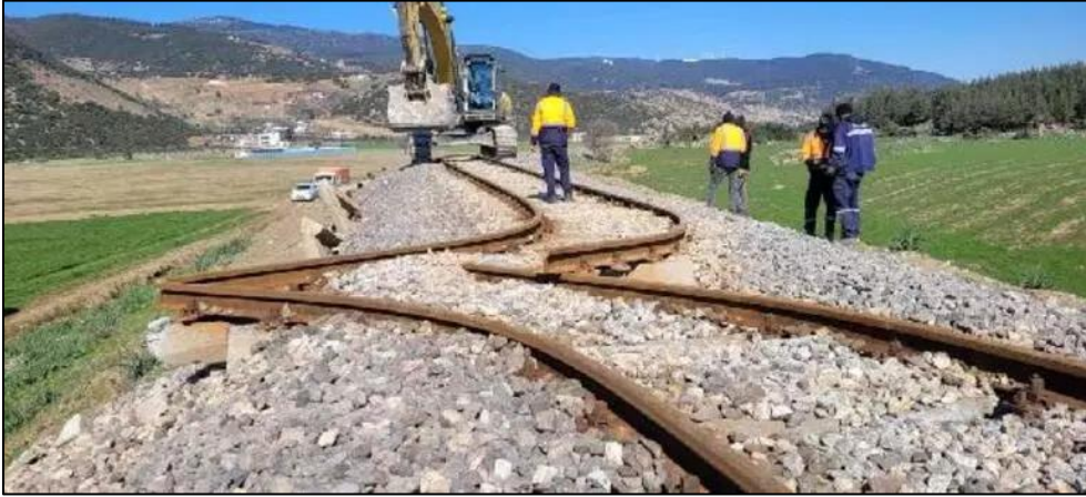
Şekil 2.6: Demiryolu hasarı-2 (Hürriyet, 2023).
