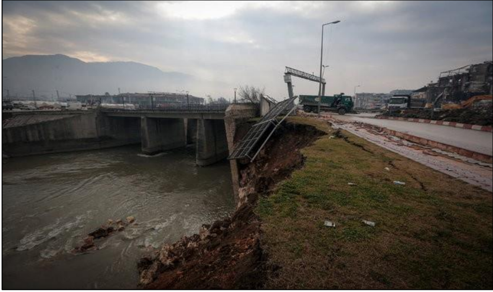
Şekil 2.7: Hatay’da hasar gören karayolu köprüsü (Yeşil Gazete, 2023).
