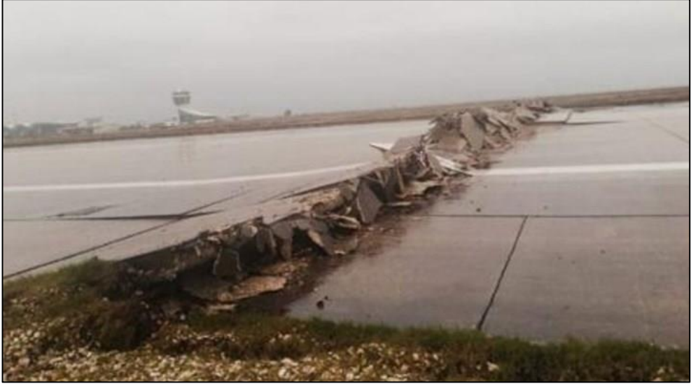
Şekil 2.4: Depremde hasar gören Hatay Havalimanı'nın pisti (Bir Gün Gazetesi, 2023).
