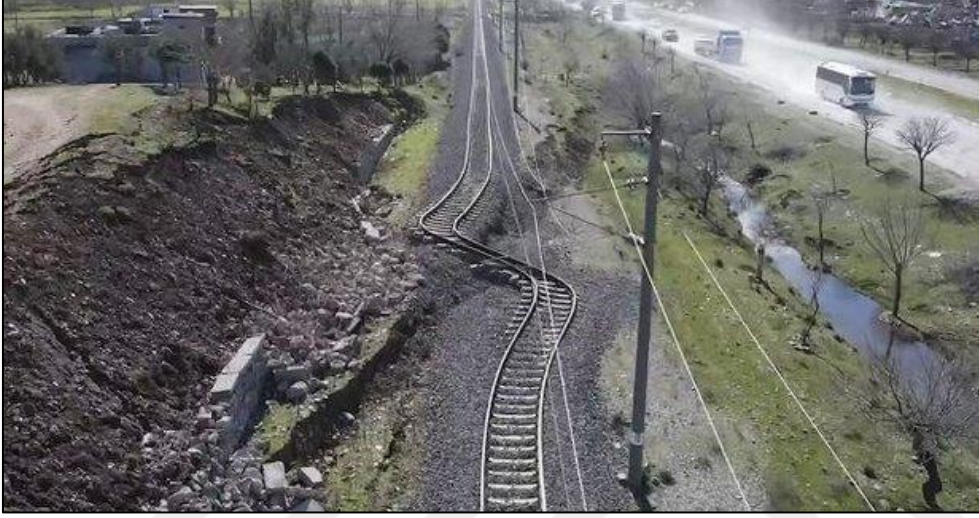
Şekil 2.5: Demiryolu hasarı-1 (Hürriyet, 2023).
