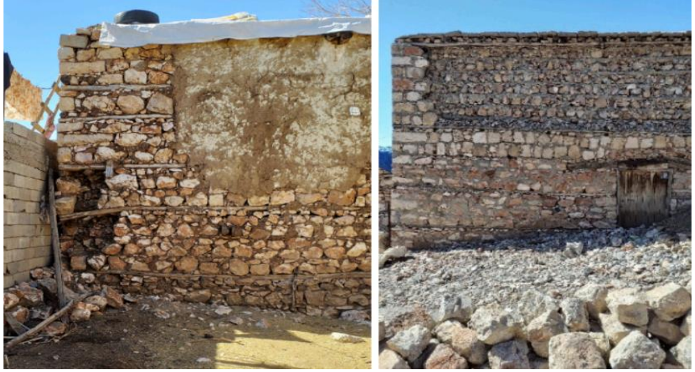
Şekil 2. 6. Katmanlar arası yetersiz bağlantı sonucu olan hasarlar
