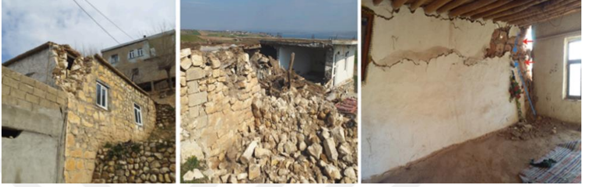
Şekil 2.4. Köşe noktalarda ayrılma hasarı
