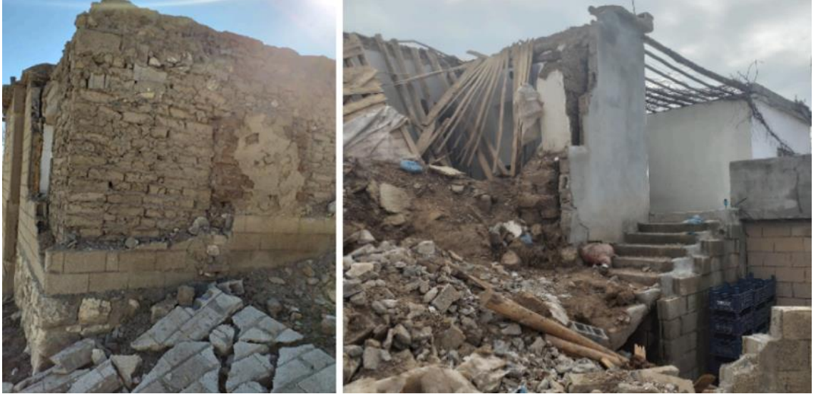
Şekil 2.5. Farklı duvar malzemeleri arasındaki yetersiz bağlantı
