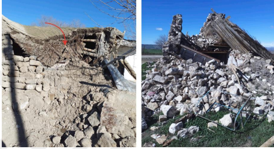
Şekil 2.2. Ağır toprak dam kaynaklı yapısal hasarlar
