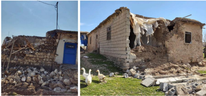
Şekil 2.3. Ağır toprak damlardan dolayı taşıyıcı duvarların düzlem dışı yıkılması
