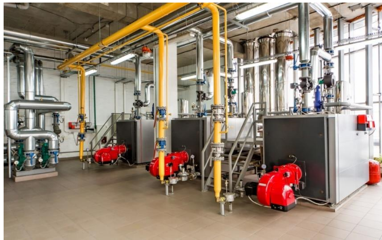
Şekil 4.12 Kazan gaz besleme boru hattı tesisatı
