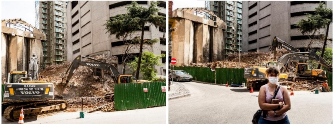
Görsel 2.2: Solda yıkım haberini aldıktan sonra alan ziyareti ve sağda elimde fabrika tuğlasıyla, 20 Temmuz 2020, Fotoğraflar: Orhan Cem Çetin.
