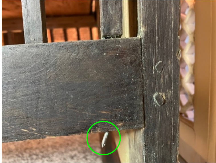
Resim 3.653. Gazanfer Ağa Camii vaaz kürsüsü gövde kısmı niteliksiz onarım izleri.
