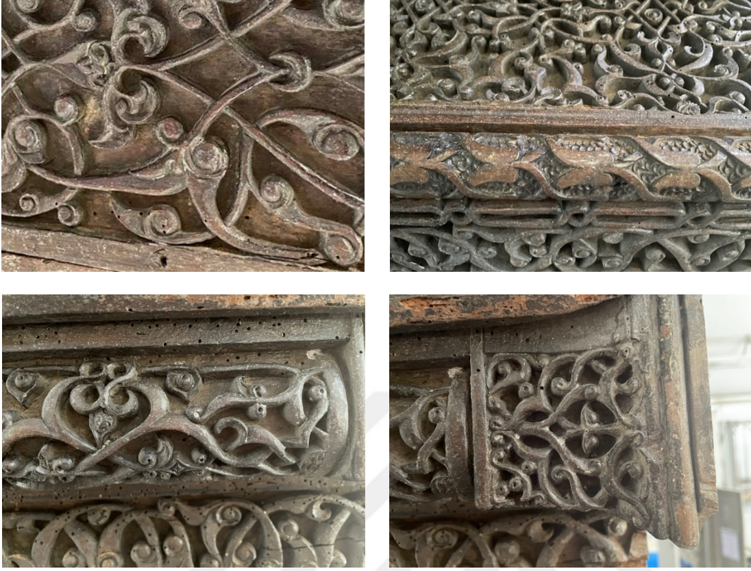
Resim 3.81. Taşkınpaşa Camii mihrabı koruyucu katmanda tabakalaşma/ayırışma örnekleri 3.
