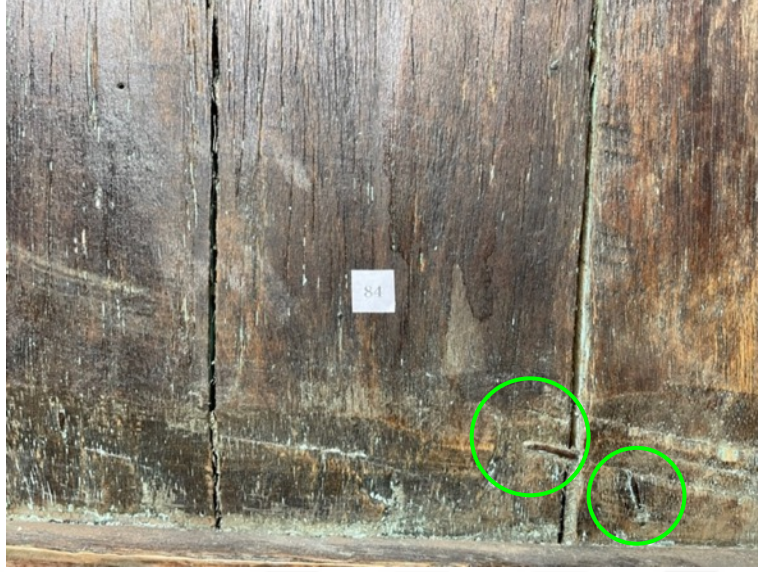
Resim 3.652. Gazanfer Ağa Camii vaaz kürsüsü taklit künde-kârî arka panel niteliksiz onarım izleri 5.
