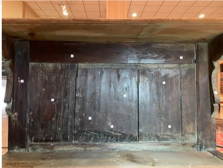
Resim 3.596. Gazanfer Ağa Camii vaaz kürsüsü taklit künde-kâri arka yüzünde oluşan çatlama ve ayrılma örneği.
