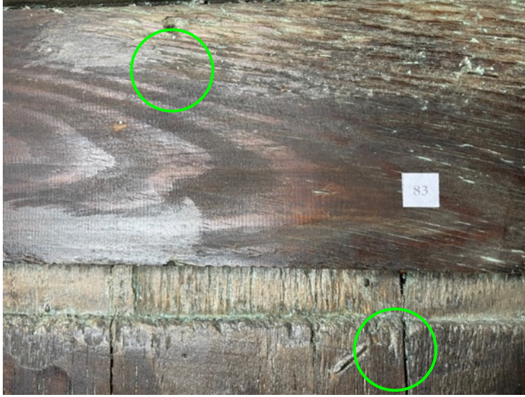
Resim 3.651. Gazanfer Ağa Camii vaaz kürsüsü taklit künde-kârî arka panel niteliksiz onarım izleri 4.
