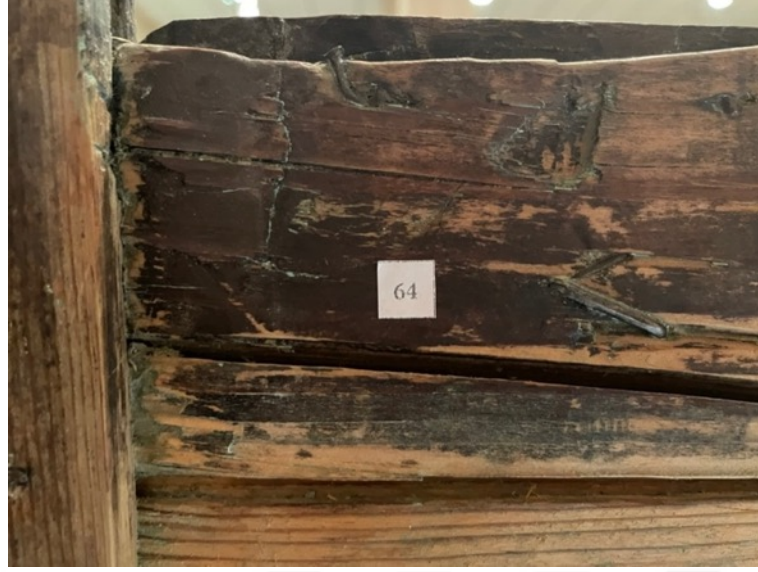
Resim 3.598. Gazanfer Ağa Camii vaaz kürsüsü arka korkuluk kısmının arka yüzünde oluşan çatlama ve ayrılma örneği 1.
