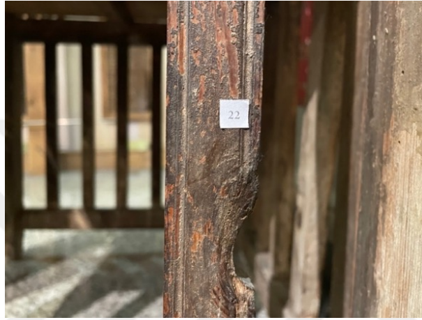
Resim 3.467. Şeyh Bahşi Mescidi vaaz kürsüsü budak kısmının yüzeyden ayrılması.
