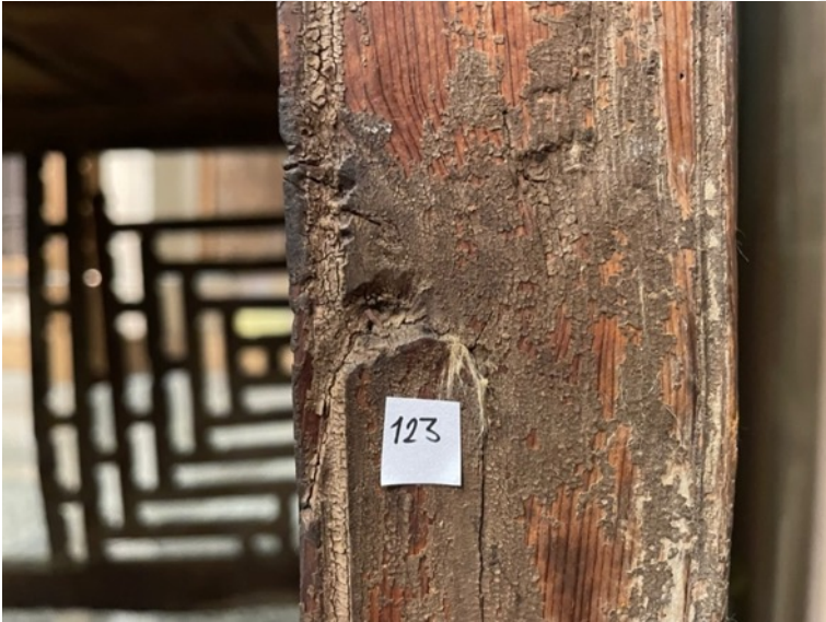
Resim 3.482. Şeyh Bahşi Mescidi vaaz kürsüsü çatlak ve ayrılma örneği 2.
