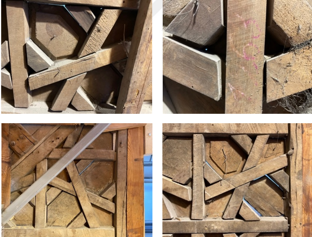
Resim 3.332. Taşkınpaşa Camii minberi aynalık iç kısmı niteliksiz onarım örnekleri 1.
