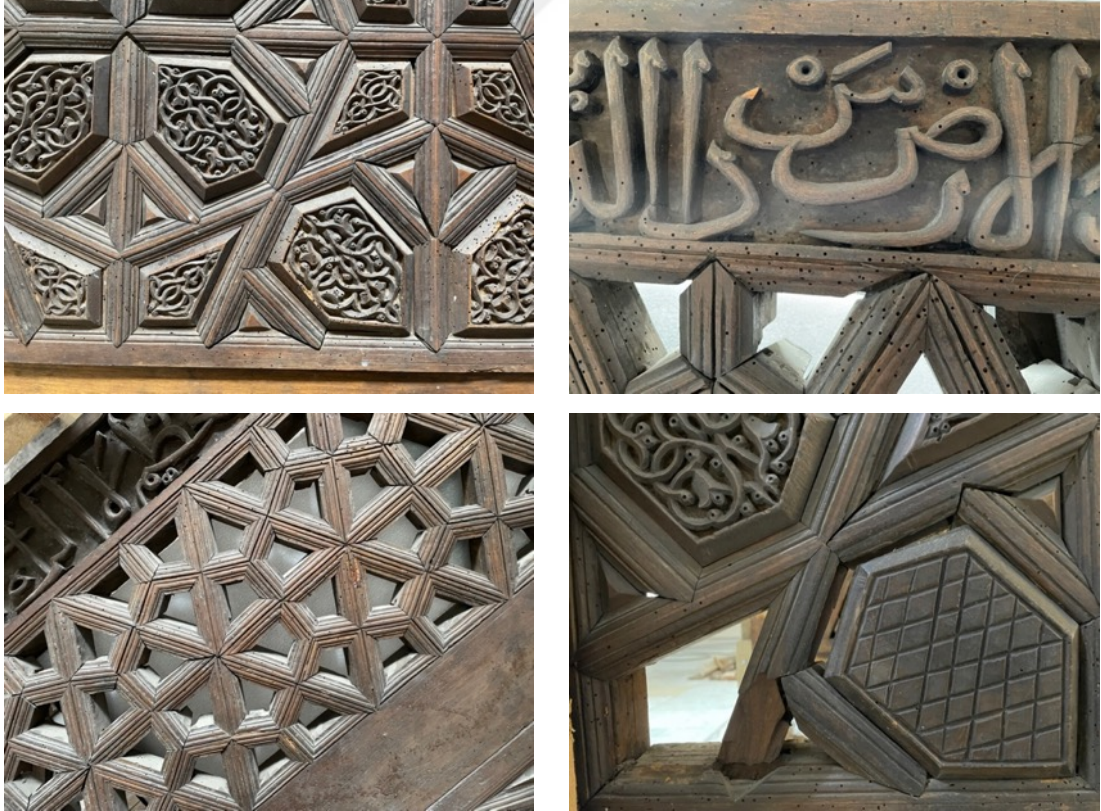
Resim 3.248. Taşkınpaşa Camii minberi süslemeli yüzeyde gevşeme/oynama örnekleri.
