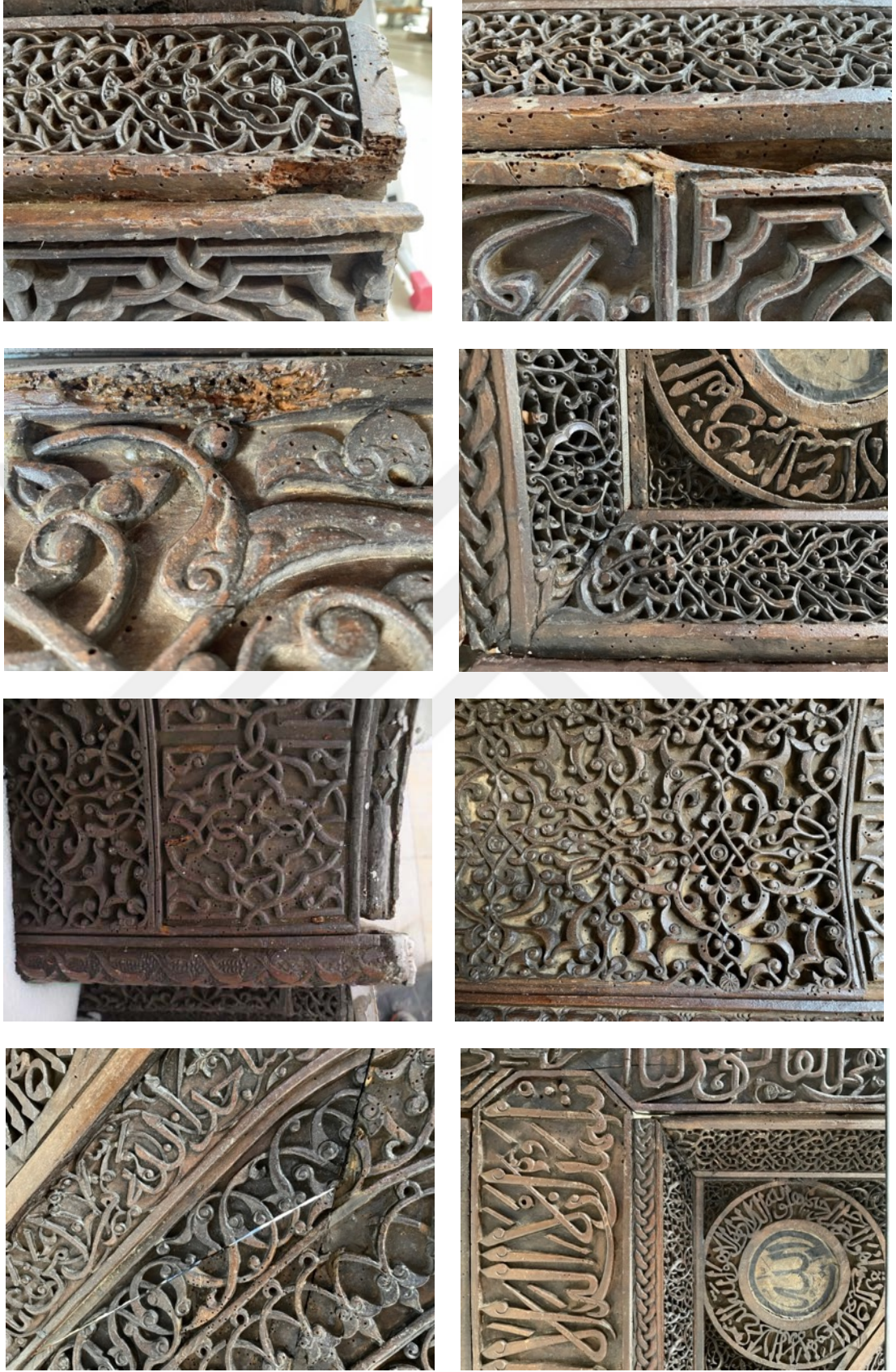
Resim 3.106. Taşkınpaşa Camii mihrabı böcek tahribatı 2.
