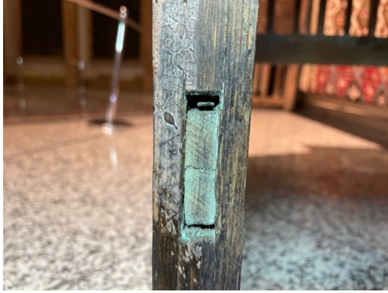
Resim 3.591. Gazanfer Ağa Camii vaaz kürsüsü ayak kısmında oluşan çatlama ve ayrılma örneği 2.
