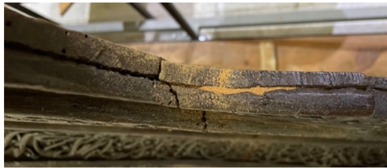
Resim 3.94. Taşkınpaşa Camii mihrabı böcek tahribatı sonrası birikinti örneği.
