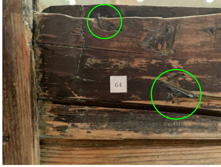
Resim 3.648. Gazanfer Ağa Camii vaaz kürsüsü taklit künde-kârî arka panel niteliksiz onarım izleri 1.
