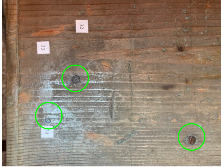
Resim 3.645. Gazanfer Ağa Camii vaaz kürsüsü rahle kısmında niteliksiz onarım izleri 1.
