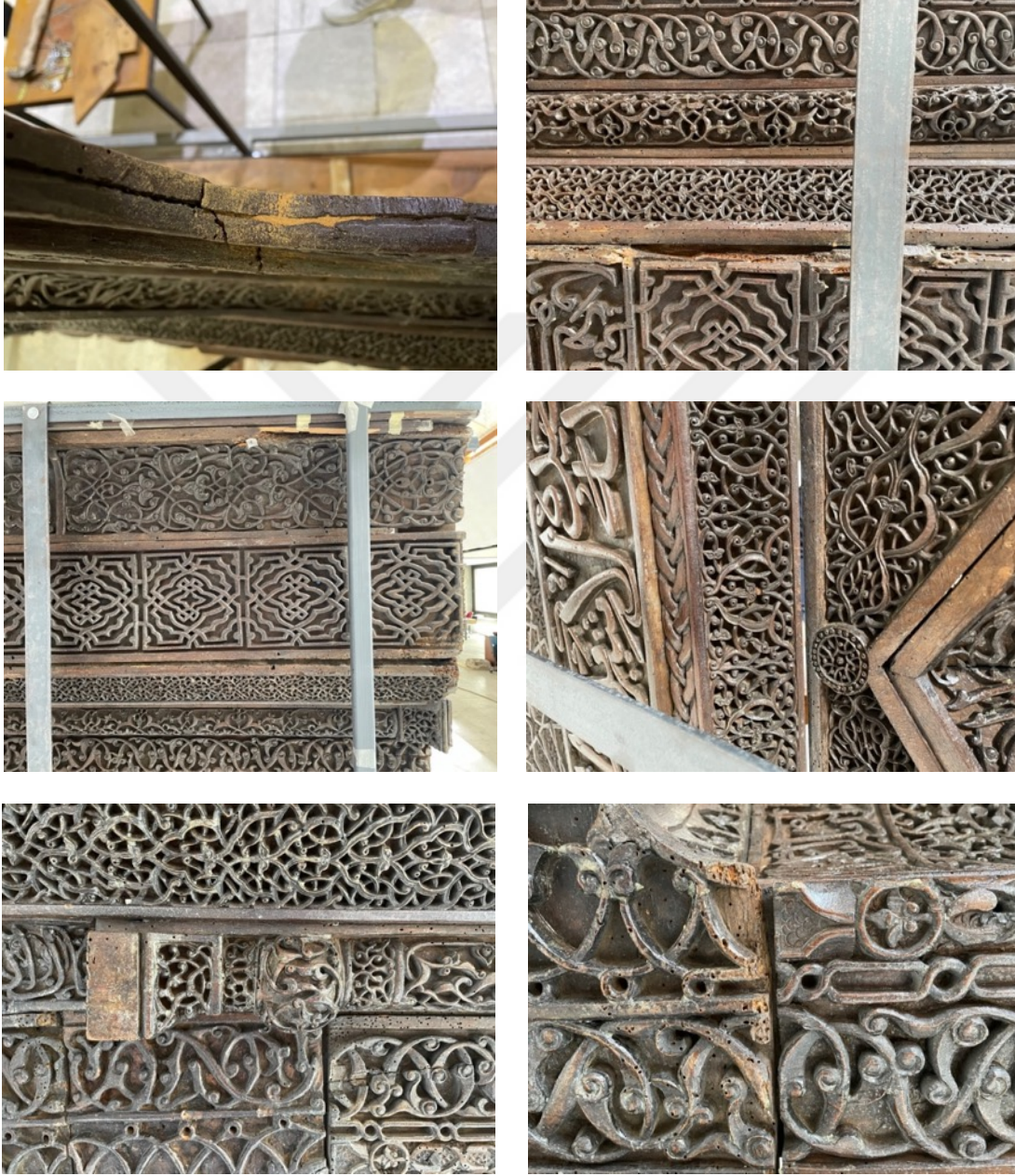
Resim 3.65. Taşkınpaşa Camii mihrabı oynama problemi detayları.
