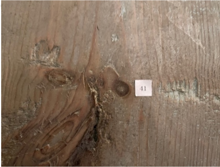
Resim 3.582. Gazanfer Ağa Camii vaaz kürsüsü rahle kısmında budak kaynaklı oluşan bozulma örneği 2.
