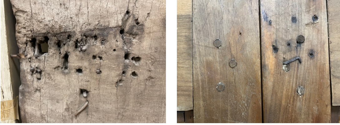
Resim 2.22. Eser yüzeyinde niteliksiz onarım ve diğer sorunlu müdahale örnekleri 3.
