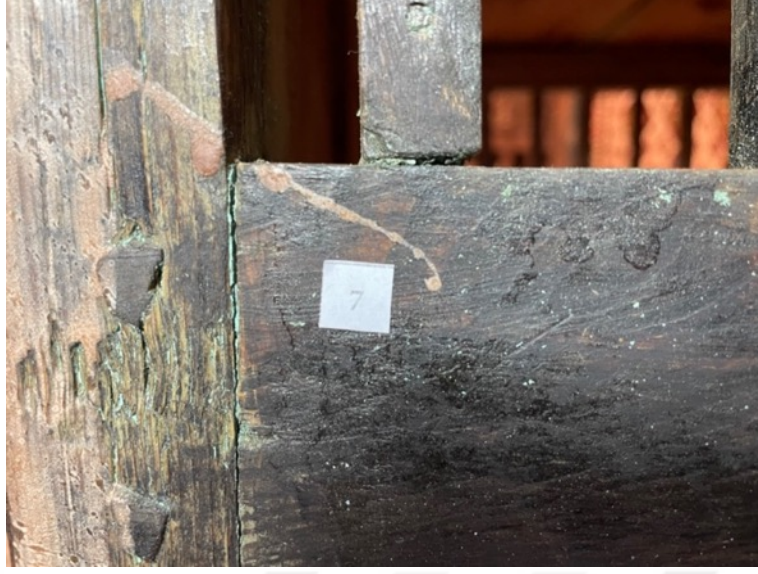
Resim 3.587. Gazanfer Ağa Camii vaaz kürsüsü yüzeyinde oluşan çatlama ve ayrılma örneği 2.
