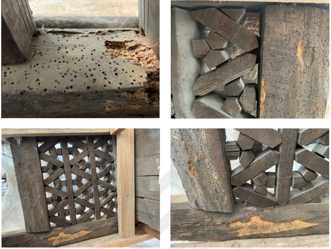
Resim 3.317. Taşkınpaşa Camii minberi böcek tahribatı örnekleri 6.
