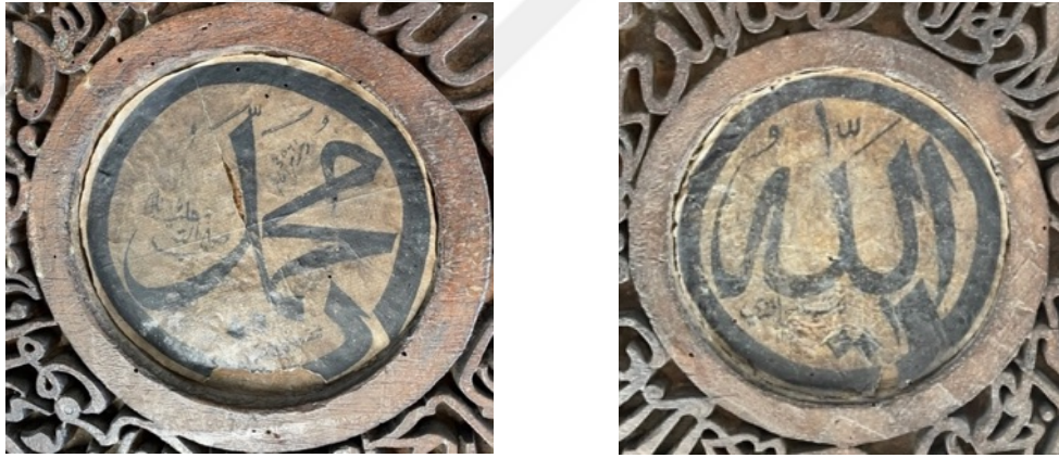
Resim 3.83. Taşkınpaşa Camii mihrabı levha kısımlarındaki erozyon örneği.
