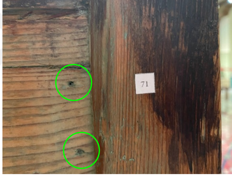
Resim 3.649. Gazanfer Ağa Camii vaaz kürsüsü taklit künde-kârî arka panel niteliksiz onarım izleri 2.
