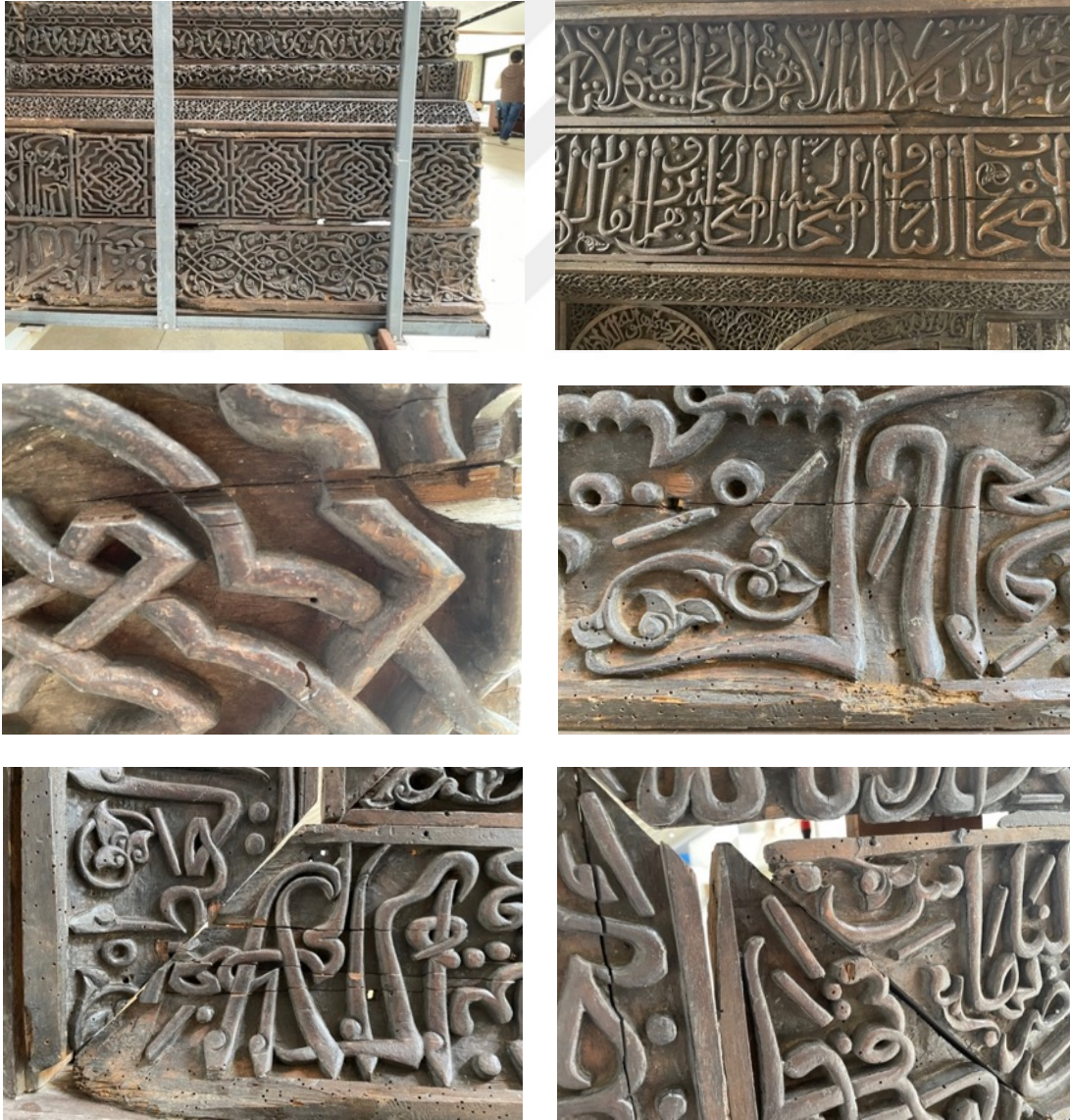
Resim 3.56. Taşkınpaşa Camii mihrabı yüzeyinde meydana gelen yarılmalar.
