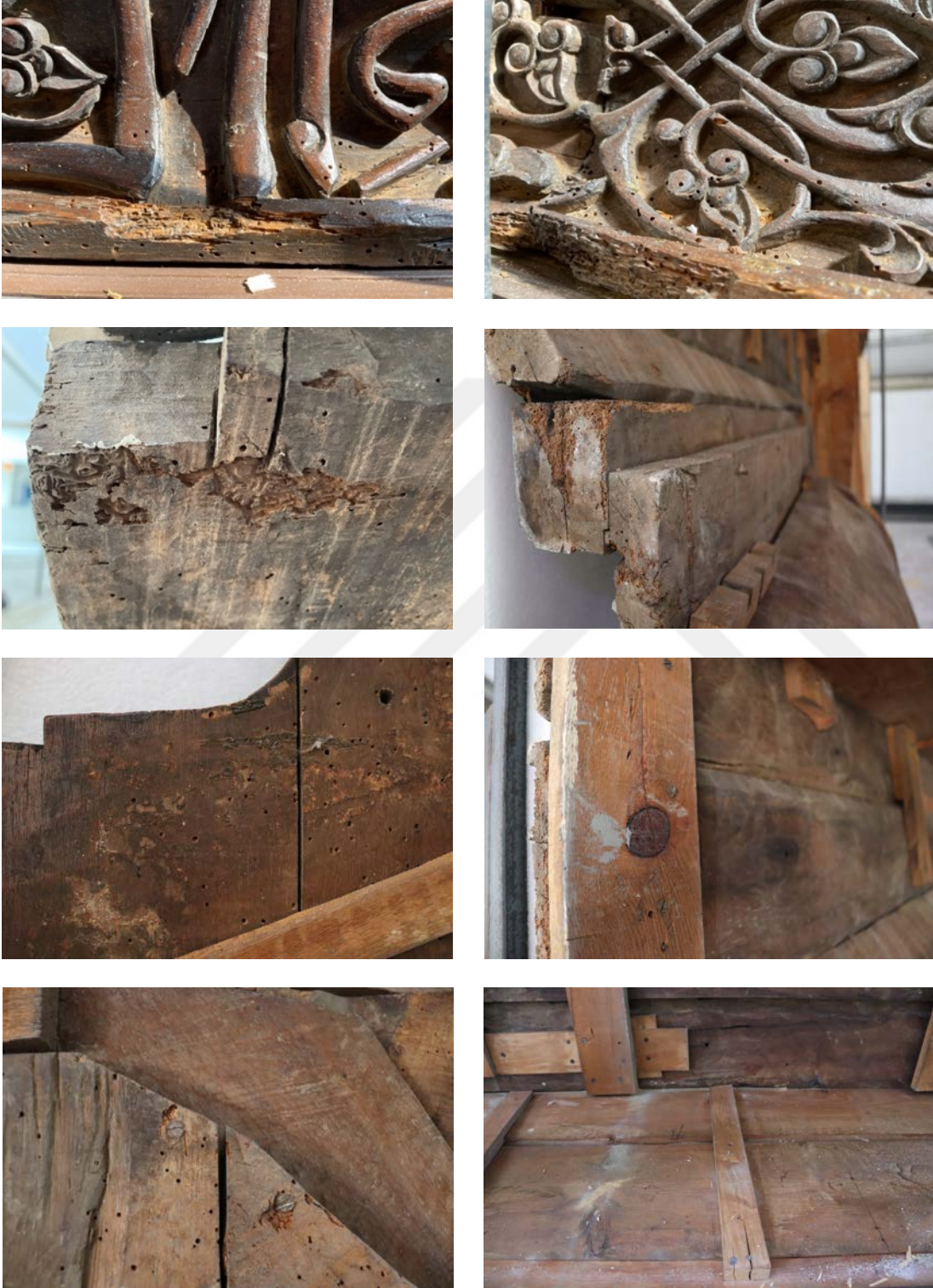
Resim 3.109. Taşkınpaşa Camii mihrabı böcek tahribatı 5.
