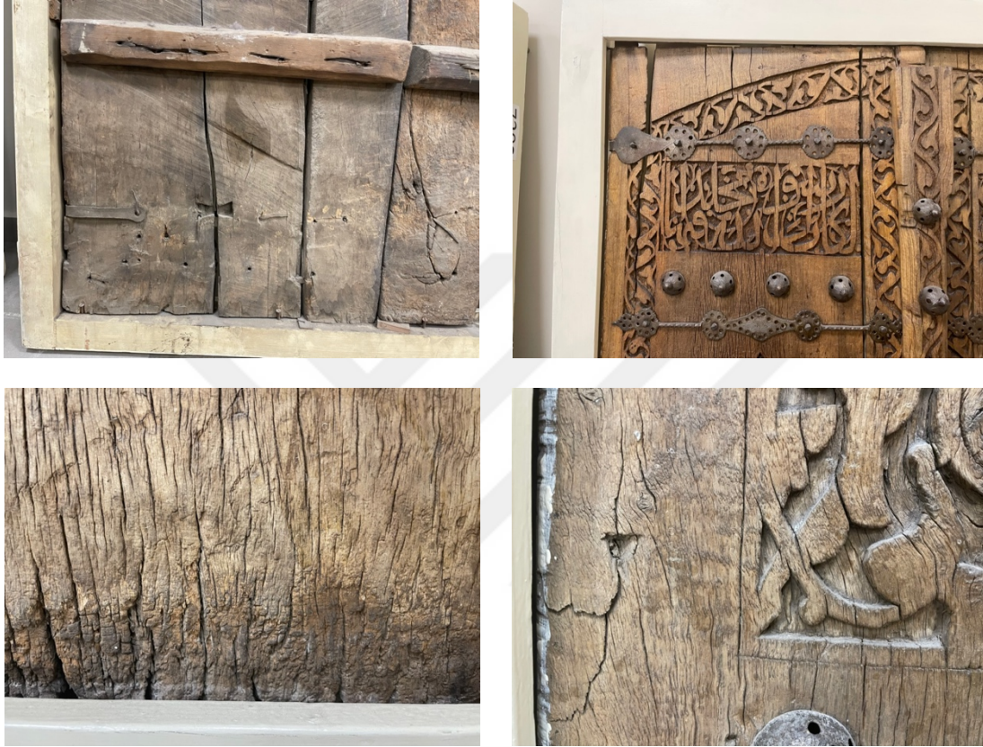
Resim 2.9. Ahşap malzemenin çalışması sonucu eserde oluşan bozulma örnekleri.
