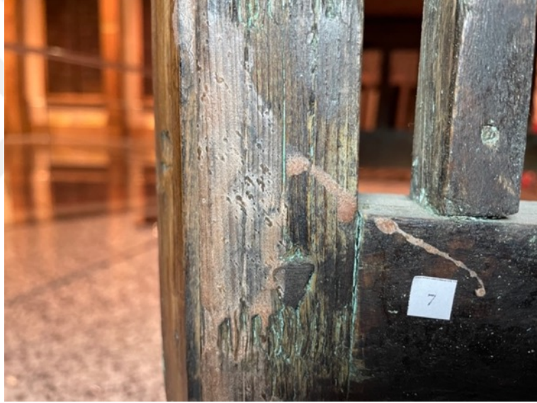
Resim 3.588. Gazanfer Ağa Camii vaaz kürsüsü yüzeyinde oluşan çatlama ve ayrılma örneği 3.
