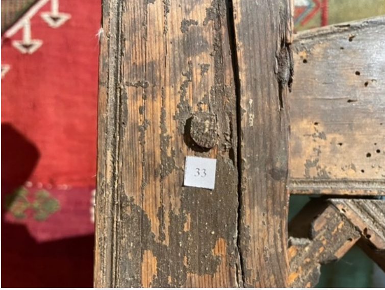
Resim 3.481. Şeyh Bahşi Mescidi vaaz kürsüsü çatlak ve ayrılma örneği 1.
