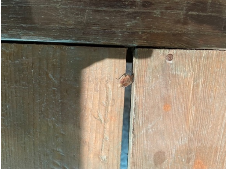
Resim 3.655. Gazanfer Ağa Camii vaaz kürsüsü ilaçlama sonrası eser yüzeyinde görülen ölü böcek örneği.
