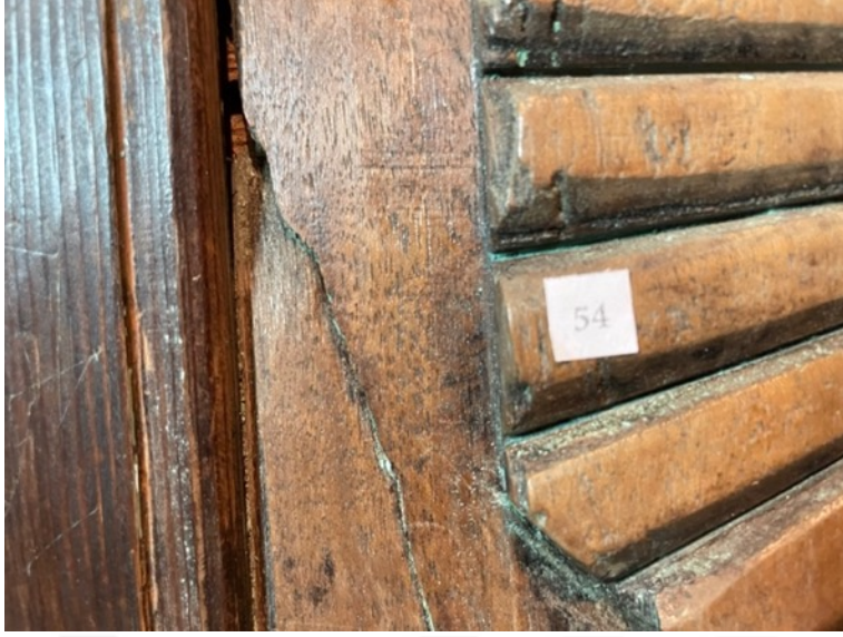
Resim 3.593. Gazanfer Ağa Camii vaaz kürsüsü süsleme kompozisyonunda oluşan çatlama ve ayrılma örneği 2.
