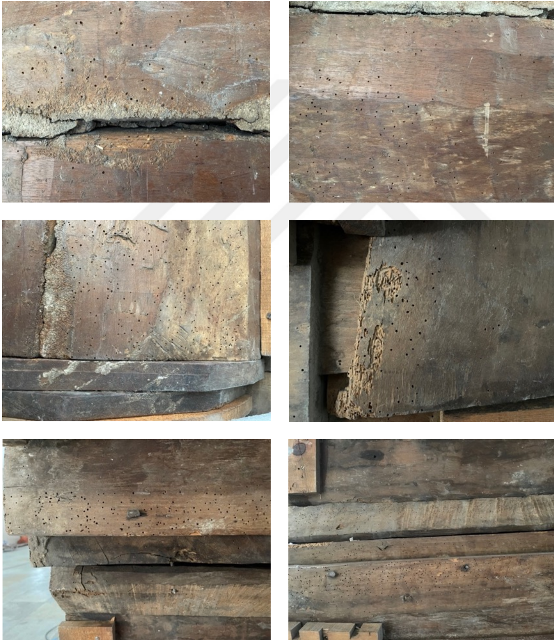
Resim 3.107. Taşkınpaşa Camii mihrabı böcek tahribatı 3.
