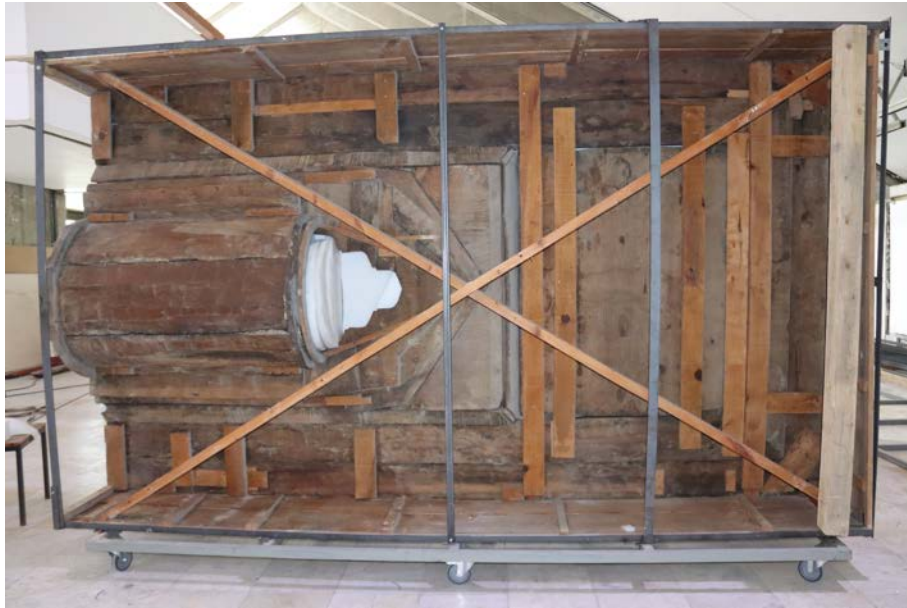
Resim 3.69. Taşkınpaşa Camii mihrabı arka kısım eksen kayması.
