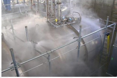
Şekil 3.26. Yüksek Basınçlı Su Söndürme Sistemleri
