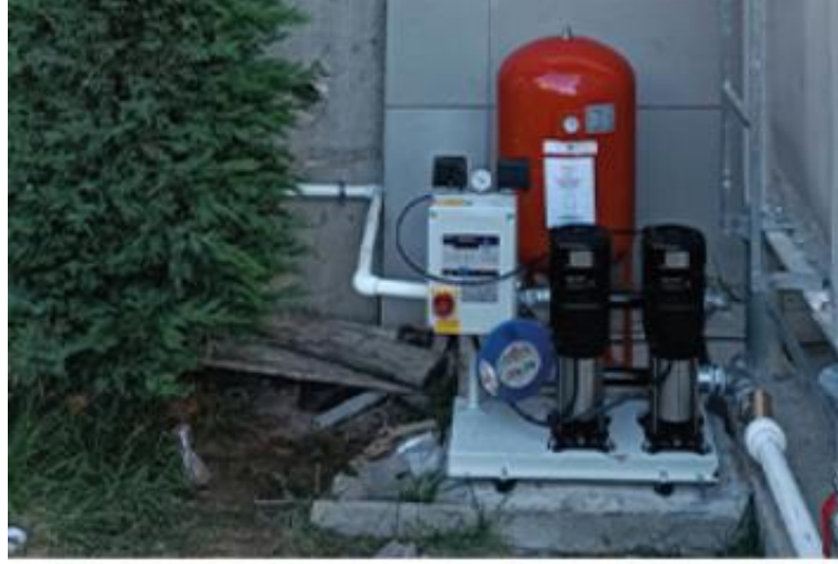
Şekil 2.16 : Tipik bir çatı üstü yağmur suyu sisteminde hidrofor ve pompa ekipmanlarının görüntüsü (Url-9).
