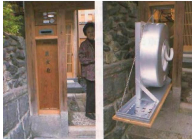
Şekil 13 Bina ile entegre söndürme sistemi (Kuzucuoğlu, 2013)
