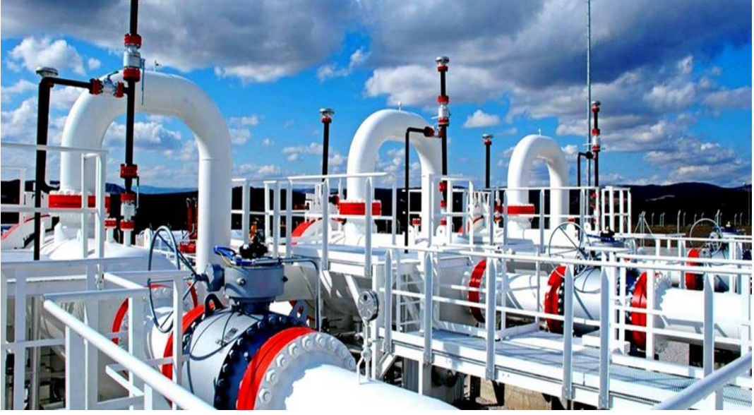
Şekil 2.6. Doğalgaz boru hattı (Economides, 2009)
