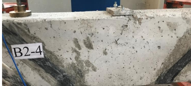
Şekil 4.85. B2-4 deney elemanında oluşan ilk hasar durumu
