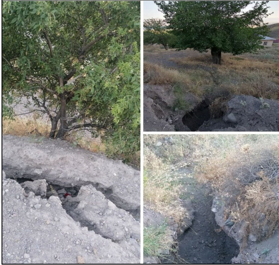
Şekil 5.25. Taşkınlar sonucu çökmelerin meydana gelmesi (Hoşk y)
