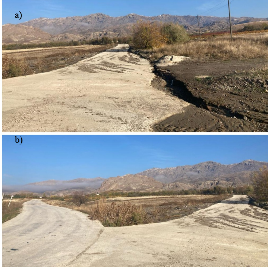
Şekil 5.56. Yağışlardan sonra beton yollarda taşkınların yaşanmasına ait bir görsel a) Kıraç b) Kıraç
