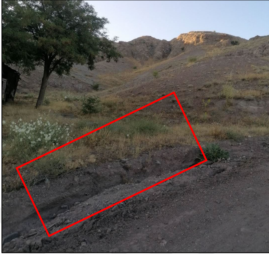
Şekil 5.36. Hoşköy yolu üzerinde oluşan oluk erozyonu
