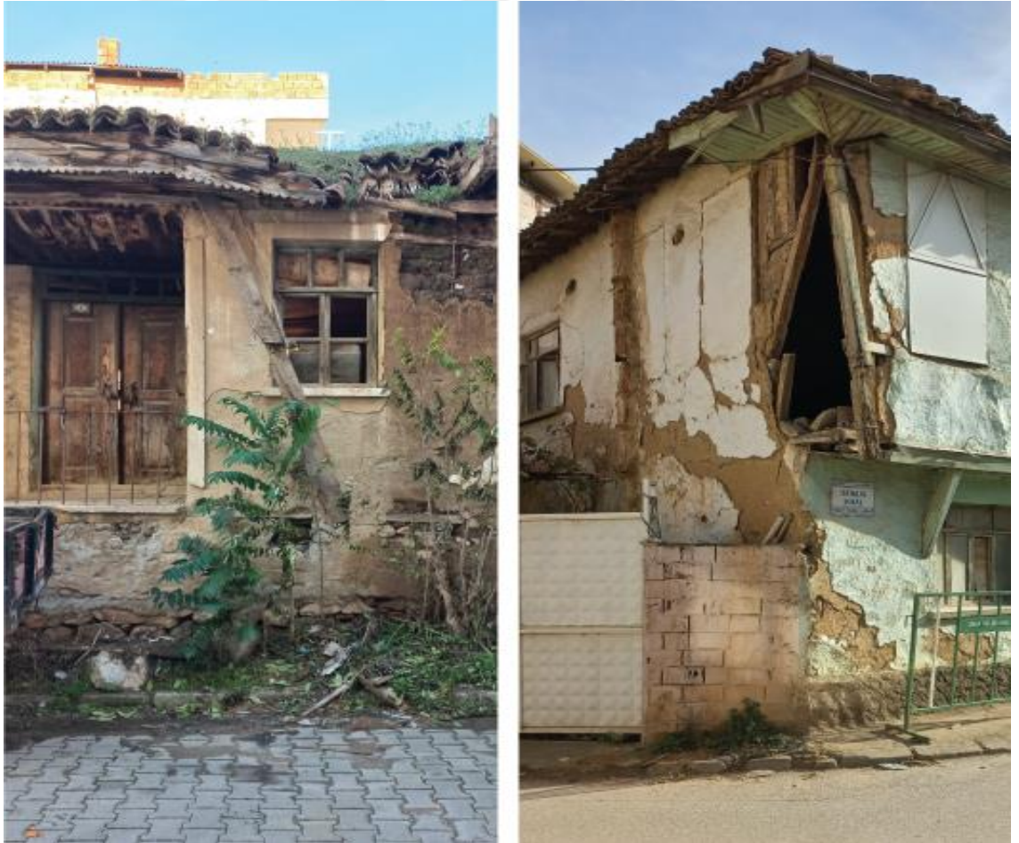
Şekil 3.34. Bölge geleneksel konut yapılarında gözlemlenen yapı bozulmaları
