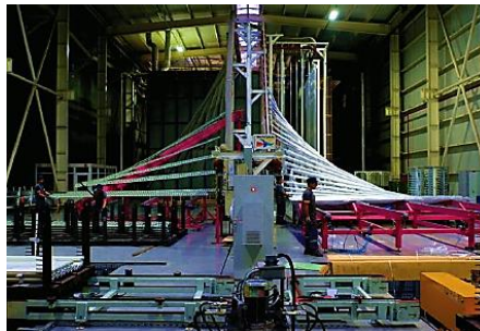
Şekil 3.14 Elektrostatik toz boya tesisi [39]
