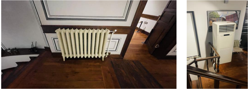
Şekil 4.74 Yapının yeni ısıtma ve soğutma elamanları
