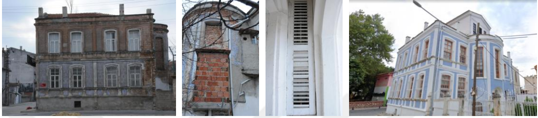
Şekil 4.128 Yapının cephesinde eski kullanıcıları tarafından yapılan sıva ve dolgular, tesisat ve yağmur suyu boruları, menfez; yapının mevcut yan ve arka cephesi (sağda)
