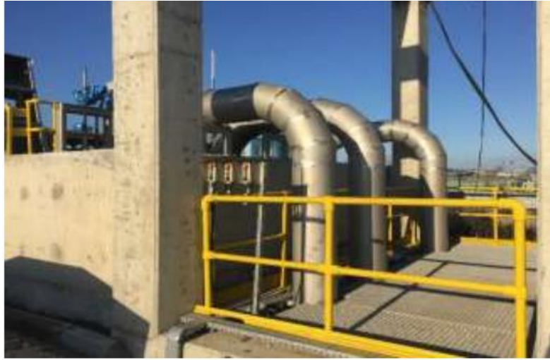
Şekil 3. 8 Giriş terfi merkezi
