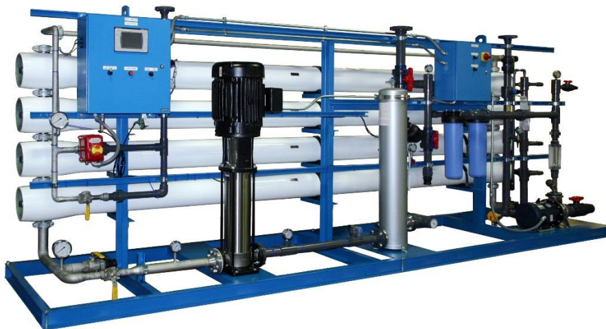
Şekil 5. 4 Ters osmoz membran kabı dizilimi (Eksen Filtrasyon Merkezi)
