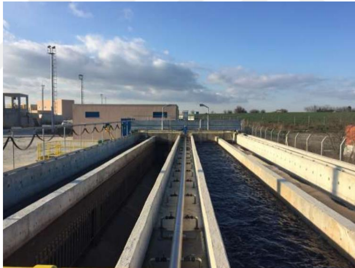
Şekil 3. 10 Havalandırma kum ve yağ tutucu ünitesi
