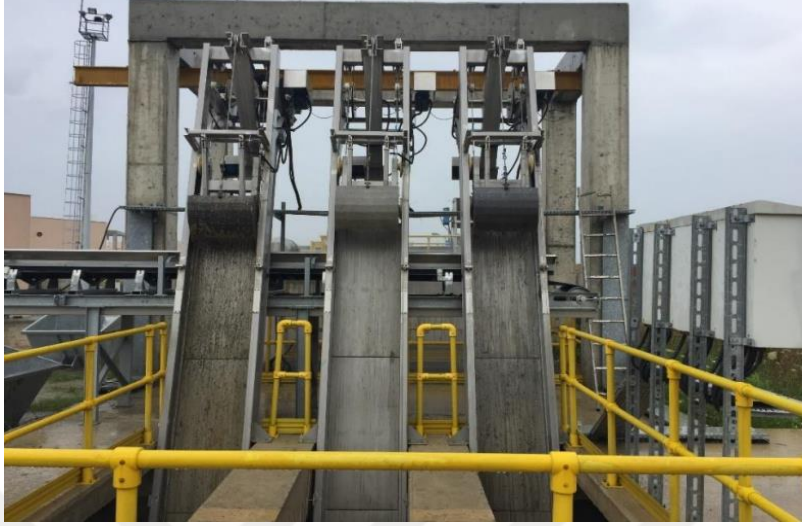
Şekil 3. 7 Kaba ızgara ünitesi
