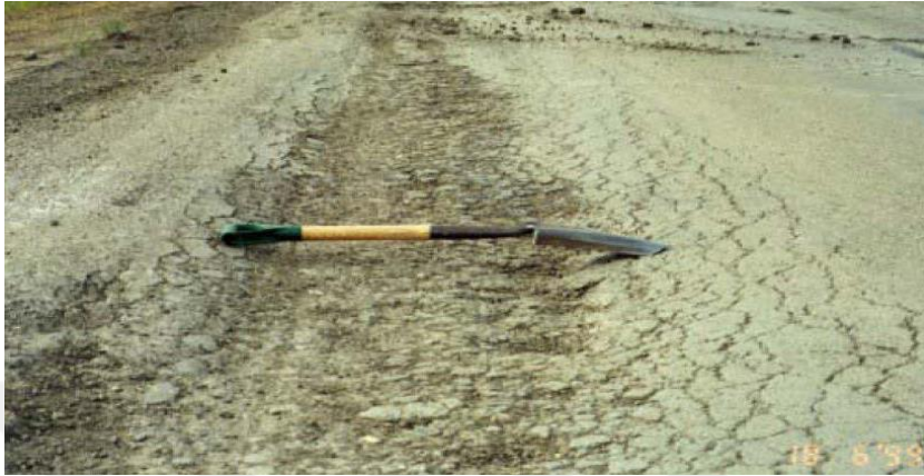
Şekil 2.9 : Esnek üstyapıda oluşmuş yerel oturma tipi bozulma[6].
