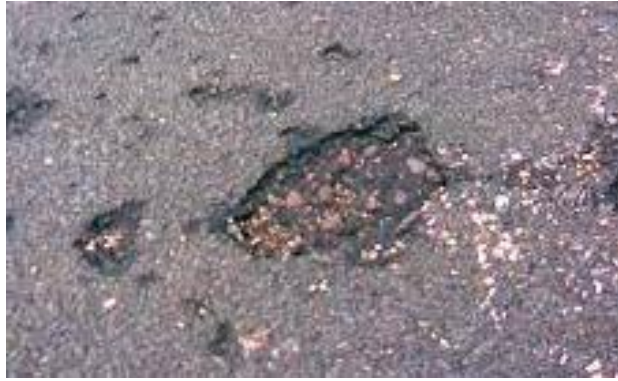
Şekil 2.11 : Esnek üstyapıda oluşmuş soyulma tipi bozulma.
