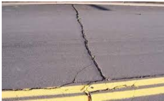
Şekil 2.4 : Esnek üstyapıda gözlemlenen enine çatlak[8].
