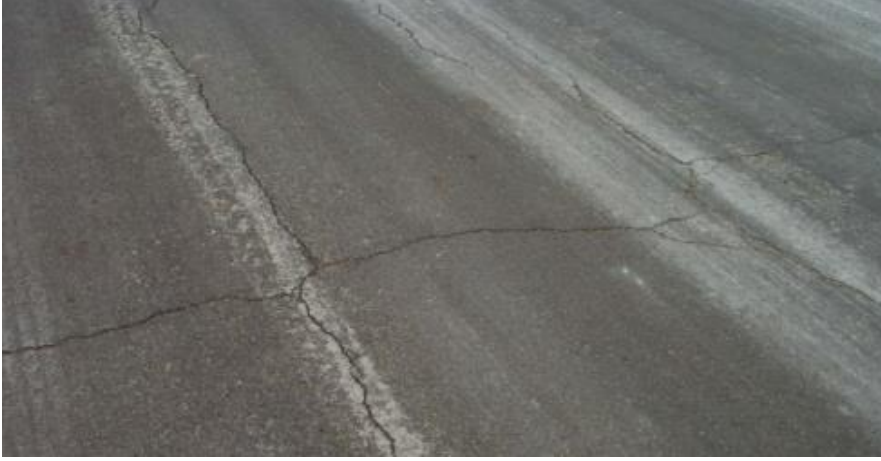
Şekil 2.6 : Esnek üstyapıda gözlemlenen blok çatlağı.
