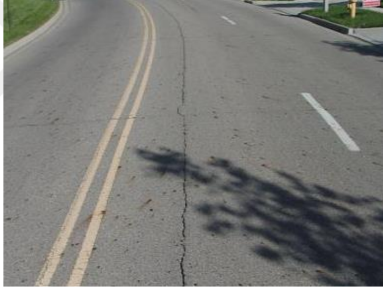
Şekil 2.5 : Esnek üstyapıda gözlemlenen boyuna çatlak[7]
