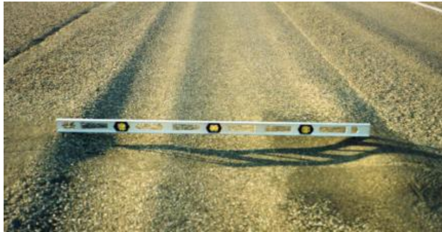
Şekil 2.8 : Esnek üstyapılarda oluşmuş bir tekerlek izi oturması.
