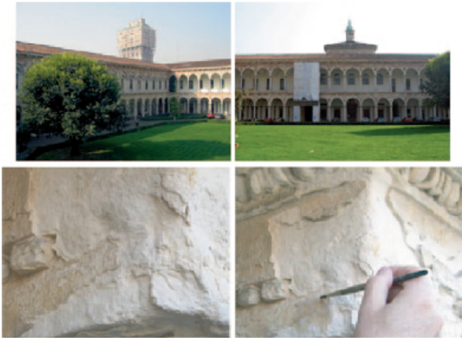
Şekil 3.8: (Üst satır) İtalya Milano’da Ca’Grande Binası, üst sağ resimde restorasyon alanı gösterilmektedir. Alt satırda Ca’Grande binasındaki bozulmalara nanopartiküllerin uygulanışı, solda uygulama öncesi durumu, sağda fırçalama ile uygulama tekniği, (Copyright 2013, Elsevier ) [28]
