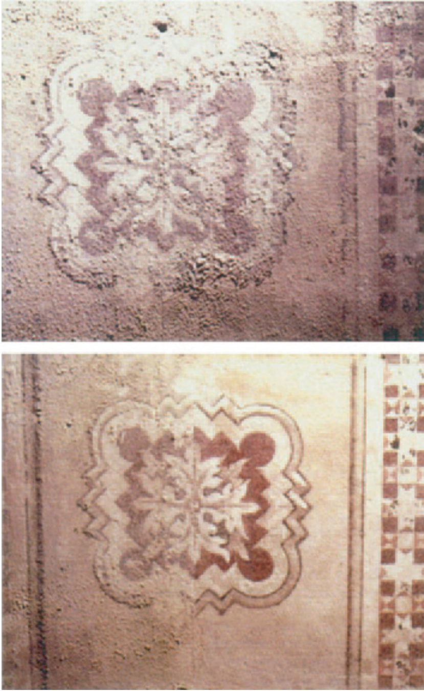
Şekil 3.16: Floransa İtalya’da Santa Maria Novella Kilisesi İspanyol Yeşil Cloister (Chiostro Verde) Şapelinde 14.yüzyıldan kalma Andrea da Firenze ‘ye ait duvar bezemeleri, (Üstte ) restorasyon öncesi bezeme üzerinde tozlanma ve pul pul ayrılma gözlenmiştir, (Altta) sağ tarafta \text{Ca(OH)}_2 partiküllerinin dispersiyonlarının uygulanması sonucu restorasyon sonrası konsolidasyon gözlenmektedir. International Institute for Conservation of Historic and Artistic Works (IIC) [28]
