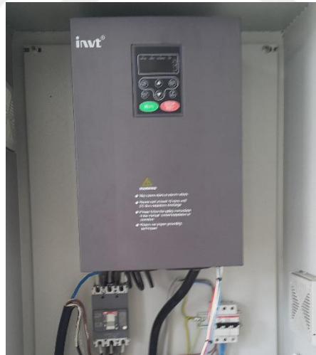
Şekil 3. 6. Pompa güç kontrolü ana birimi
