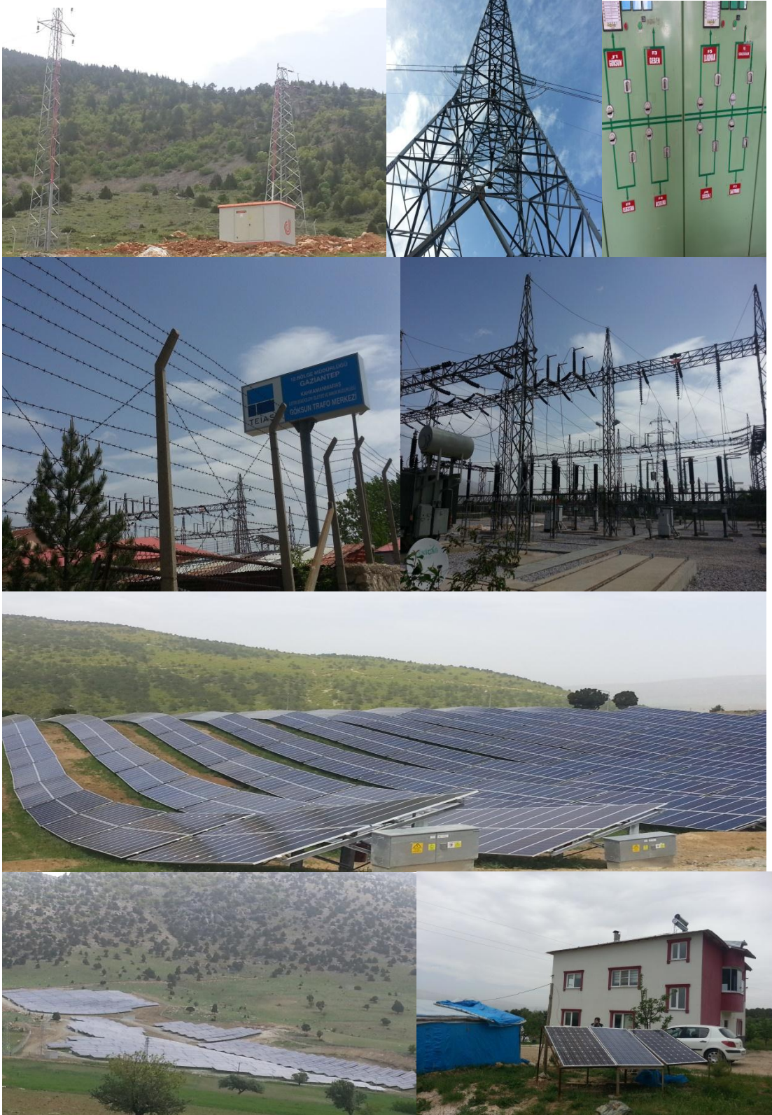
Şekil 7.19. Göksun Monoblok - 3.0 Enerji Hattı, Trafo Merkezi, Kurulu Paneller
