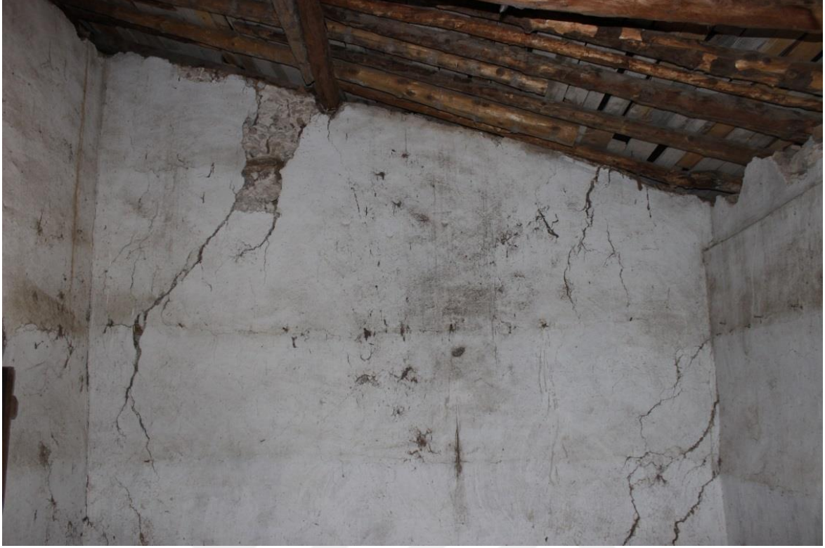
Resim 4.102. Oda mekânındaki sıva dökülmeleri ve çatlamları
