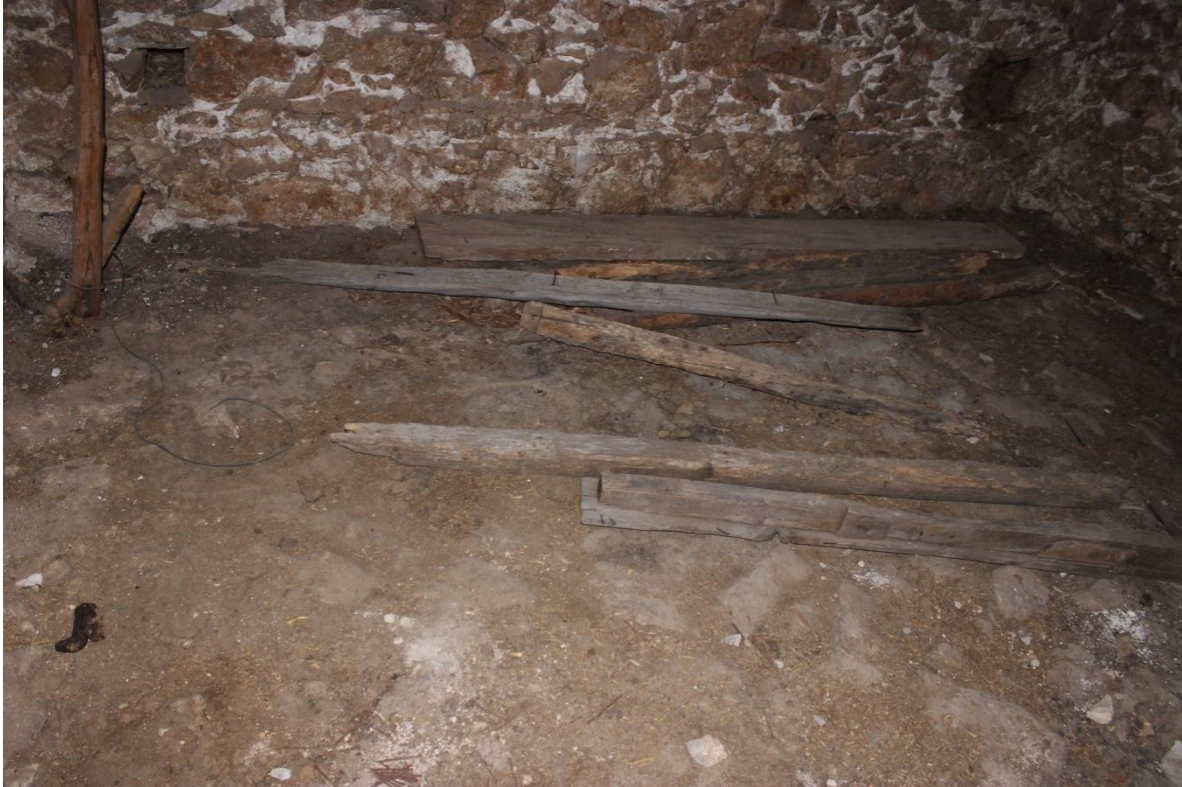
Resim 4.37. Depo mekânı kuzeydoğu duvarı taş malzemedeki kayıp
