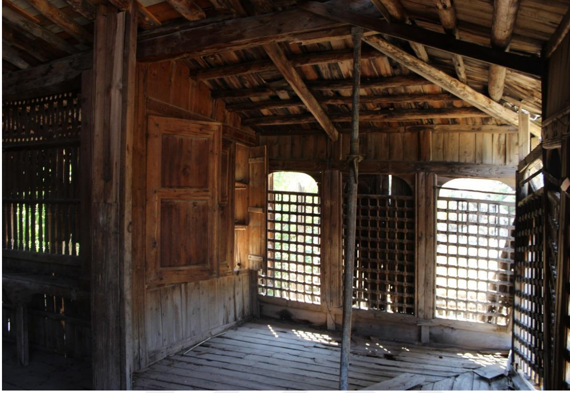
Resim 4.110. Çıkmanın tavanına destek olarak sonradan eklenen metal dikme
