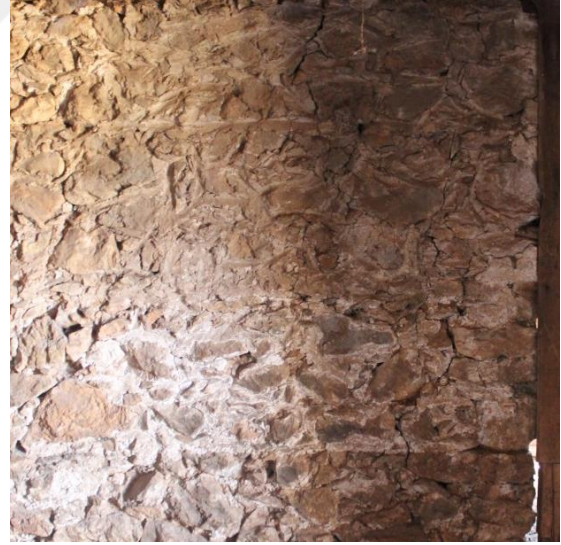
Resim 4.147. Evüğün strüktürel çatlak
