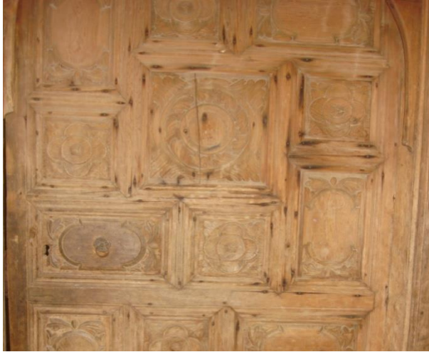
Resim 4.131. Ahşap kapıda çatlak
