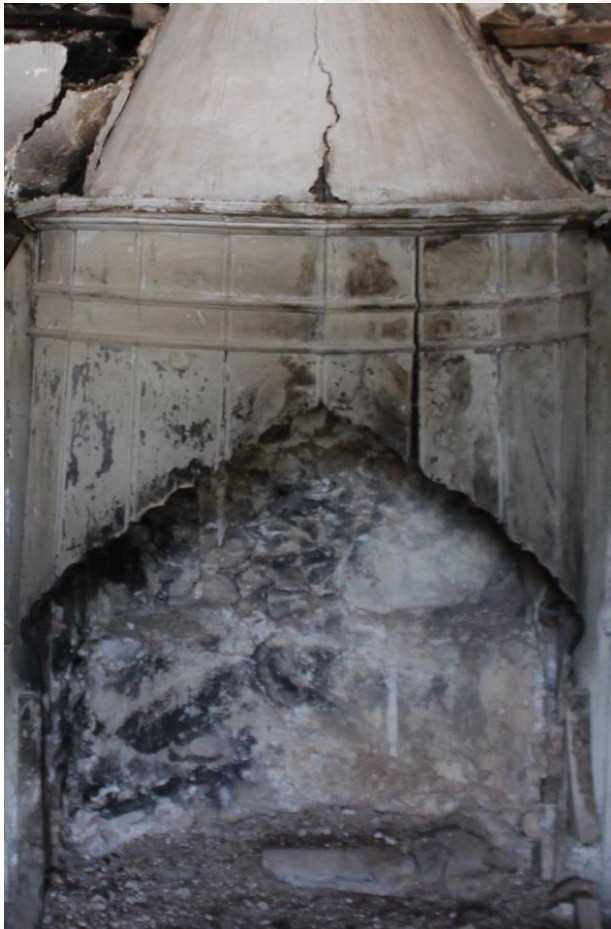
Resim 4.137. Ahşap ocağın malzemesinde kırılma
