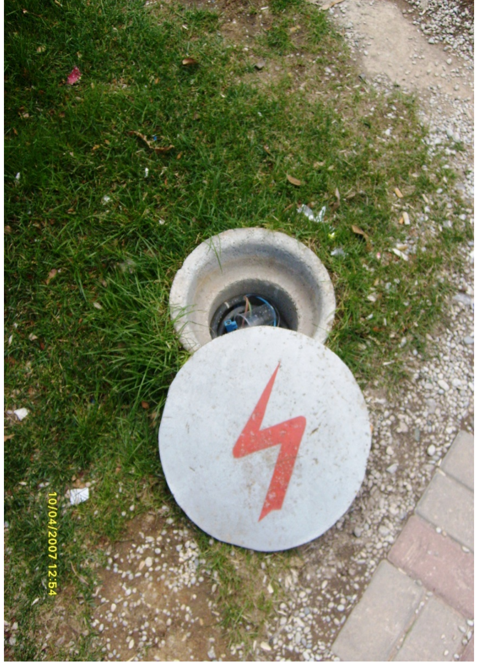
Şekil 4.12. Nenehatun parkında açıkta duran elektrik kabloları (Orijinal 2007).
