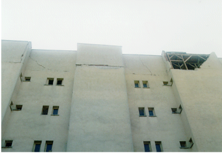
Şekil 2.1. Kısmen yıkılmış kalkan duvarı ve SSK hastanesi lojmanı
