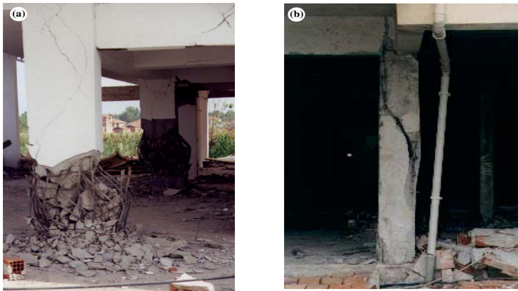
Şekil 2.5. Yetersiz etriye nedeniyle kolonda kesme kırılması (Saatçioğlu vd 2001)
