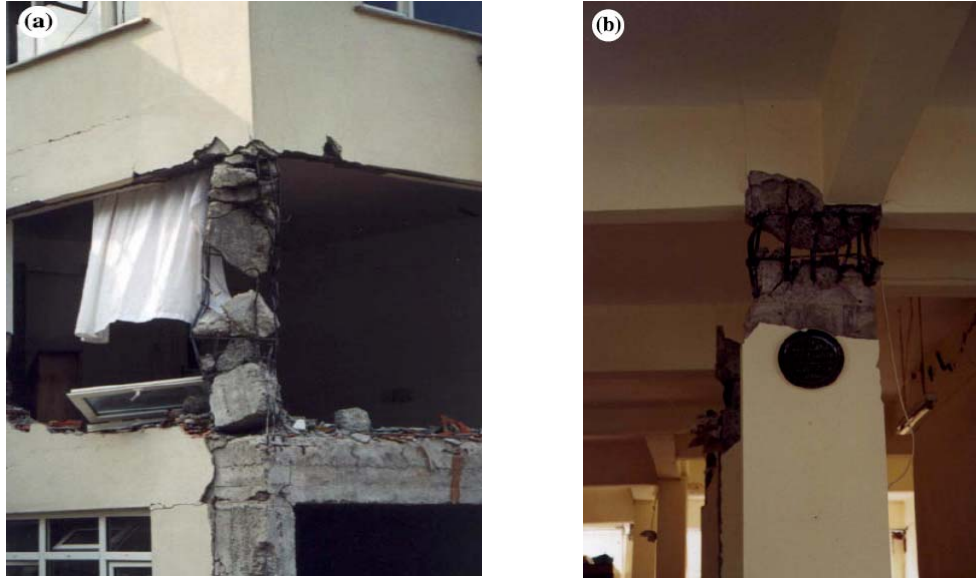
Şekil 2.6. Yetersiz etriye nedeniyle kolonda basınç kırılması (Saatçioğlu vd 2001)
