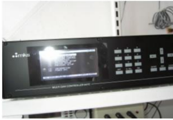
Şekil 3.24. Gaz Akış-Basınç Kontrol Sistemi
