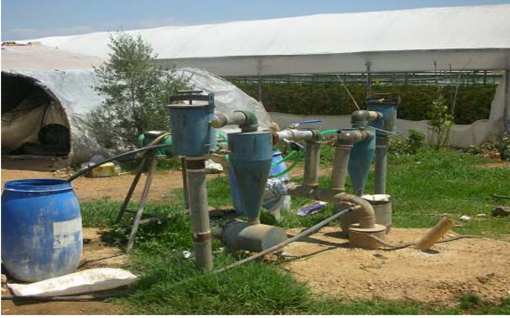
Şekil 5. 4 Araştırma seralarında kullanılan bir kontrol biriminin görünüşü.
