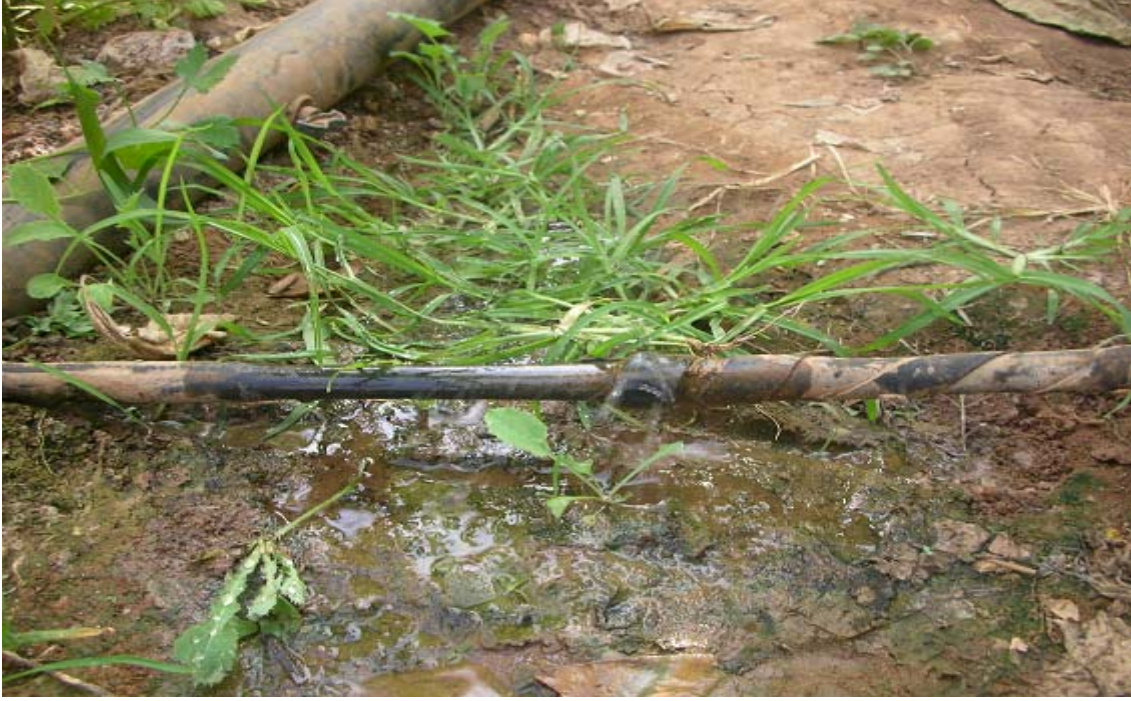
Şekil 5.5 Yıpranmış bir Lateral boru üzerinde su sızıntısının görünüşü.
