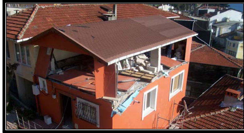
Şekil 3.9. Çatı Yükseltilerek Yapılan Kaçak Bir Çalışma Örneği (www.ibb.gov.tr)
