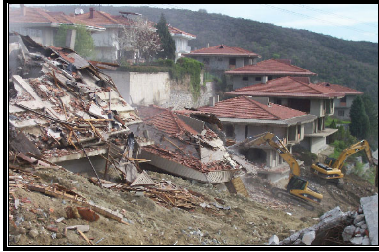
Şekil 4.11. Maden Mahallesi’ndeki Yeni Dostlar Sitesinin Yıkılmasından Görünüm
