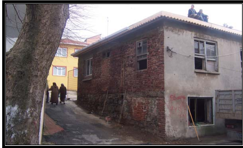
Şekil 3.7. Rumelifeneri'nde Yanlış Tadilat Yapılan Tescilli Bir Yapı Örneği
