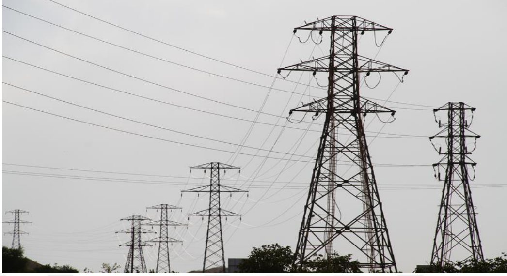
Şekil 2.12. Yüksek gerilim hatları
