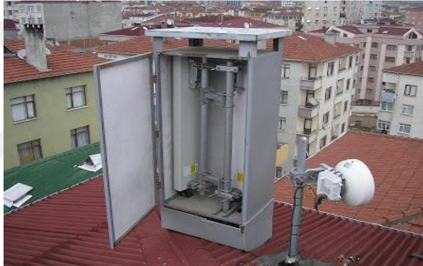
Şekil 2.10. Baca görünümlü bir baz istasyonu
