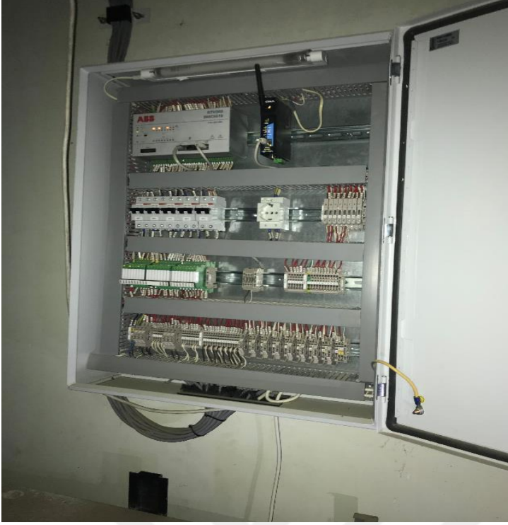
Şekil 3.10. SCADA panosunun montajının yapılmış hali
