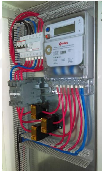
Şekil 5.3: Çift yönlü elektronik elektrik sayacı tesis görünümü
