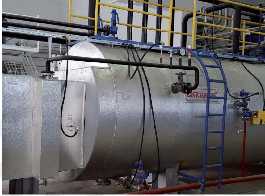
Şekil 4.4. Atık ısı kazanı (Barış Mühendislik).
