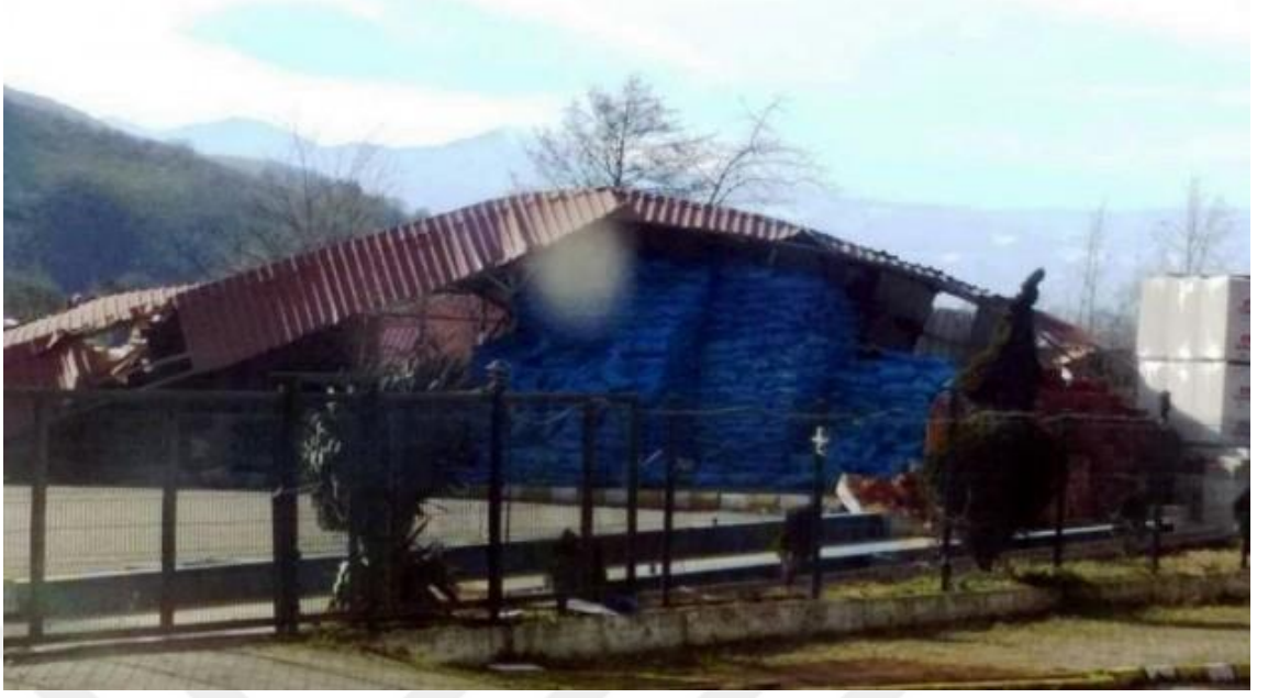
Şekil 1.4. Sakarya’da iş yeri deposu çatısı uçması(URL-4).
