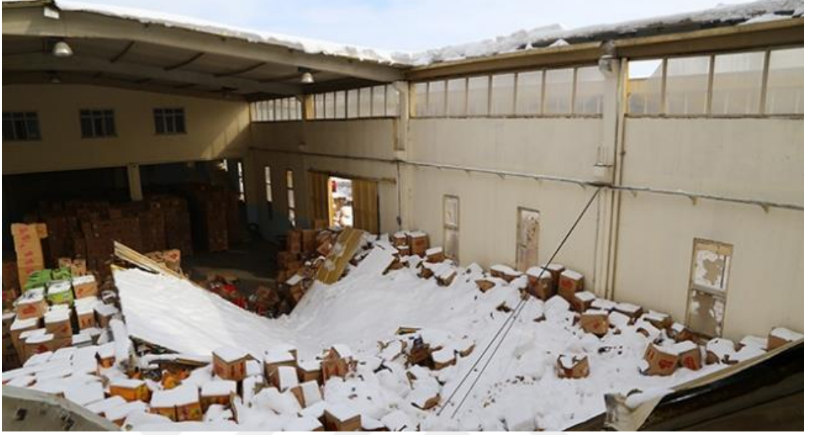
Şekil 1.2. Konya’da fabrika çatısı çökmesi(URL-2).
