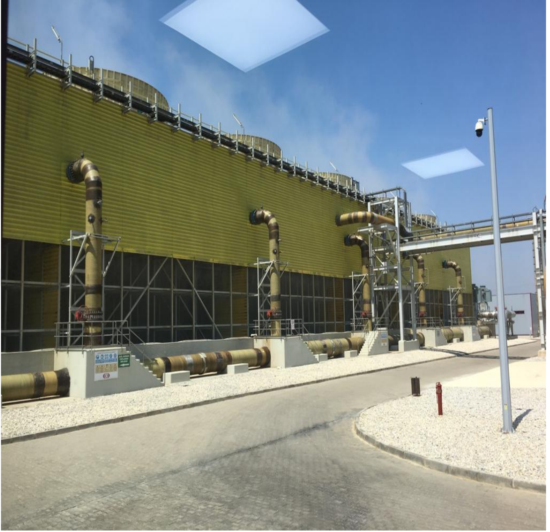
Şekil 6.4. Flash tip jeotermal santrali su soğutma kulesi
