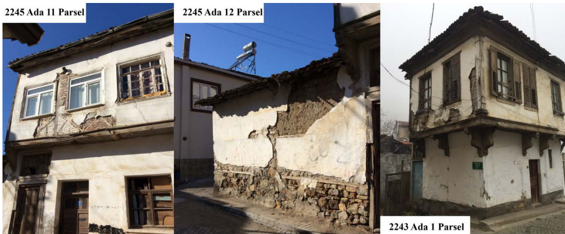
Şekil 3.106 Hafif yapısal problemler veya yüzey ve dolgu malzemesinde bozulmalar olan yapılar (M.D. – 2018)
