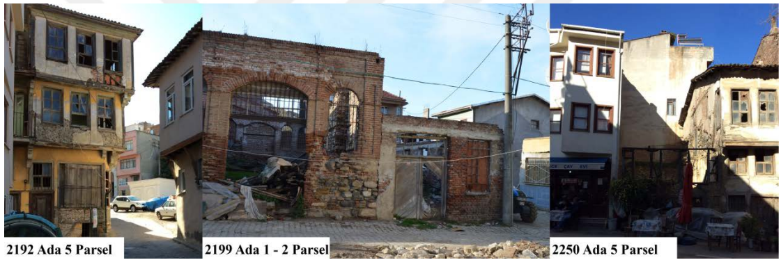
Şekil 3.105 Kısmen veya tamamen yıkılmış durumdaki yapılar (M.D. – 2018)
